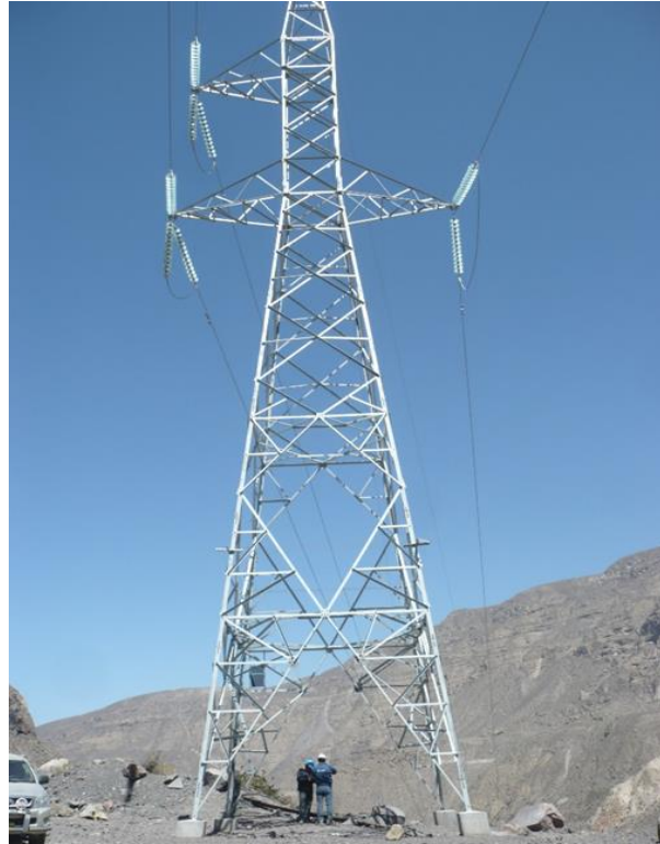
Figura 2. Estructura metalica de linea de transmision electrica.
