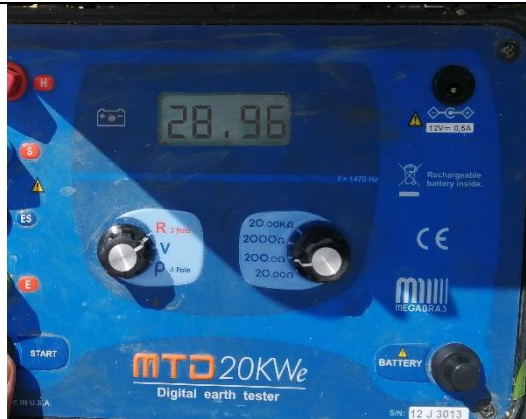
Foto 43.- Medición antes de la mejora 28.96 \Omega
