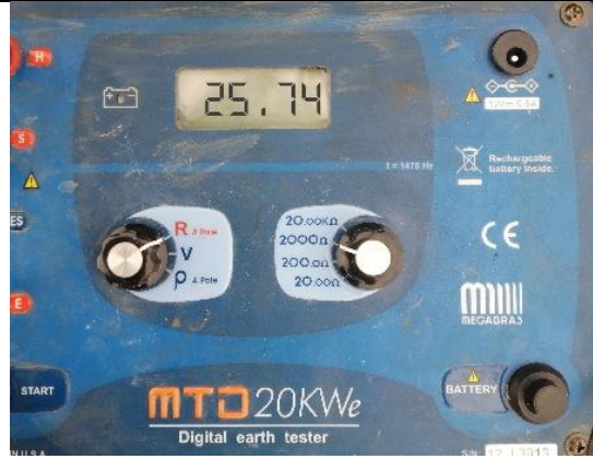
Foto 17.- Medición antes de la mejora 25.74 \Omega
