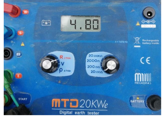
Foto 36.- Medición después de la mejora 4.80 \Omega
