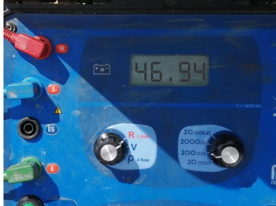
Foto 53.- Medición antes de la mejora 46.94 \Omega
