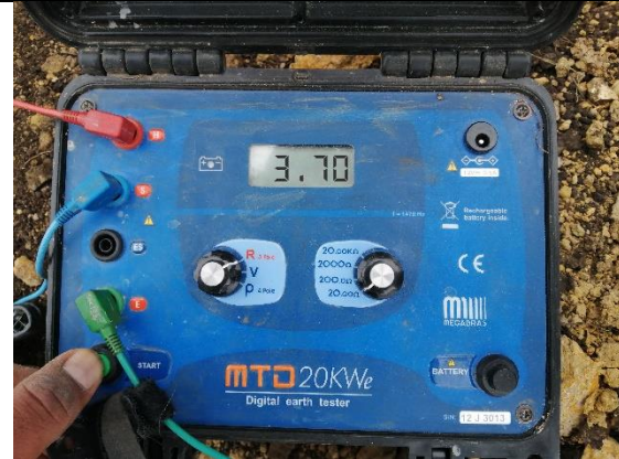
Foto 14.- Medición después de la mejora 3.70 \Omega
