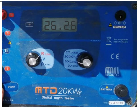
Foto 37.- Medición antes de la mejora 26.26 \Omega
