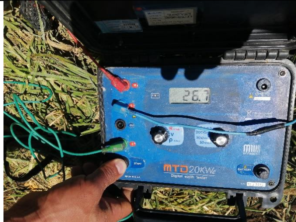
Foto 41.- Medición antes de la mejora 26.74 \Omega
