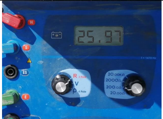
Foto 51.- Medición antes de la mejora 25.97 Ω
