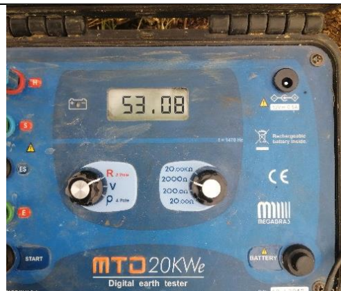
Foto 15.- Medición antes de la mejora 53.08 \Omega
