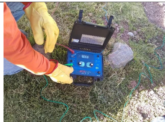
Foto 18.- Medición después de la mejora 4.30 \Omega
