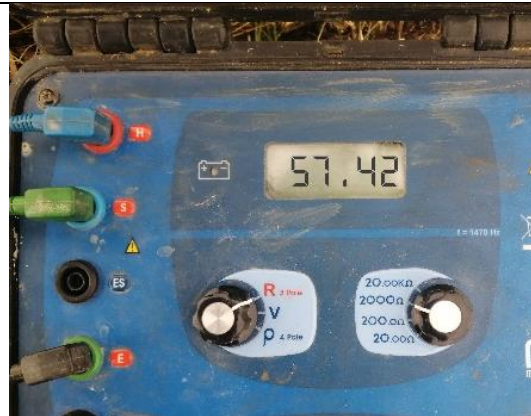
Foto 19.- Medición antes de la mejora 57.42 \Omega
