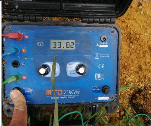
Foto 7.- Medición antes de la mejora 33.82 Ω
