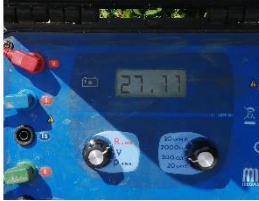
Foto 29.- Medición antes de la mejora 27.11 Ω
