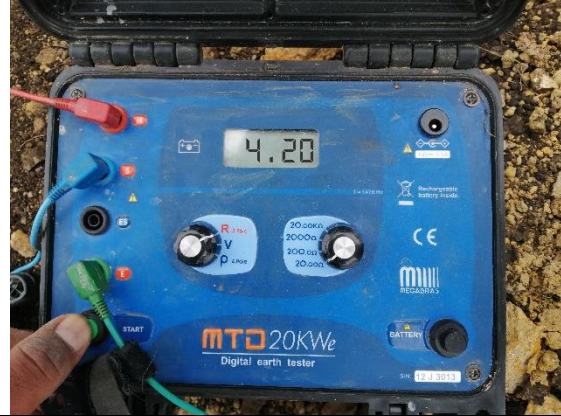
Foto 24.- Medición después de la mejora 4.20 \Omega
