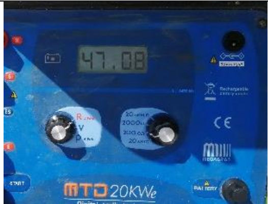
Foto 31.- Medición antes de la mejora 47.08 Ω
