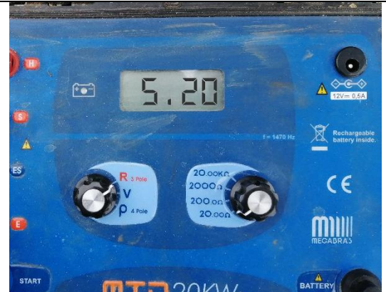
Foto 48.- Medición después de la mejora 5.20 Ω
