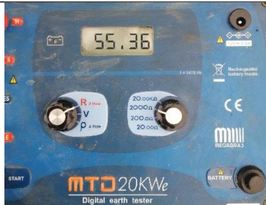
Foto 21.- Medición antes de la mejora 55.36 \Omega
