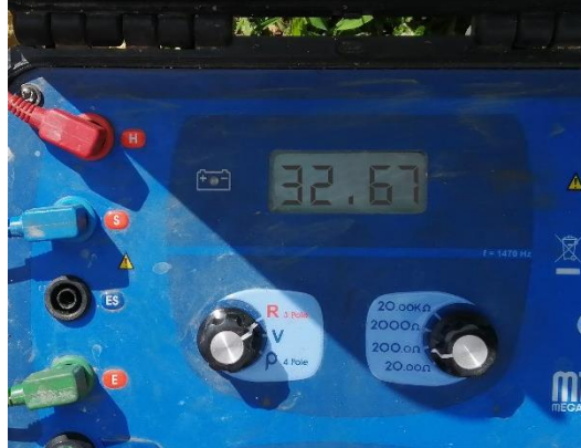
Foto 35.- Medición antes de la mejora 32.67 \Omega
