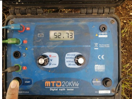
Foto 13.- Medición antes de la mejora 52.73 \Omega
