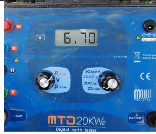
Foto 42.- Medición después de la mejora 6.70 \Omega
