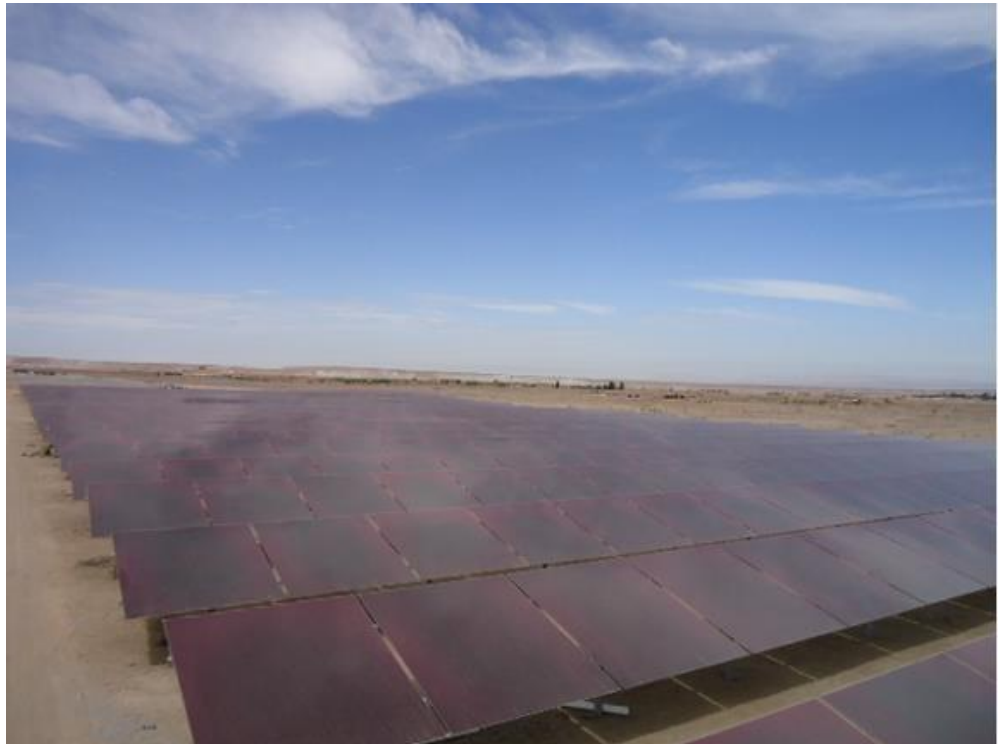
Figura 11. Central solar repartición 22MWP (Arequipa-Perú)
