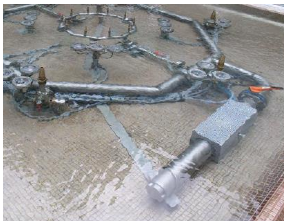
Figura 14 Realimentación de agua.
