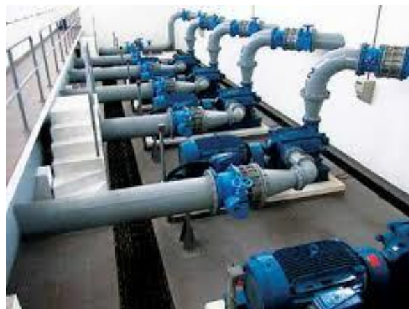
Figura 13 Cuarto de bombas.
