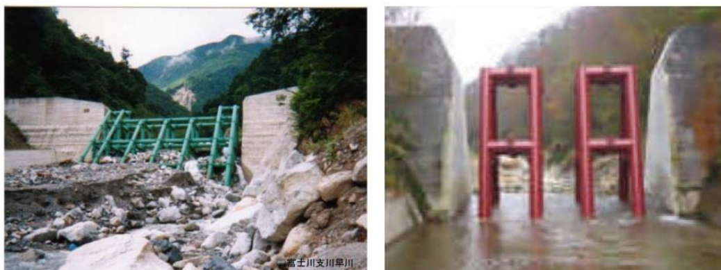
Figura 16 Tuberías de acero abiertas, imagen de la izquierda, Presas permeables, Uesugi-tani river, Japón. Fuente: (Extraído de SABO Division 2006)
