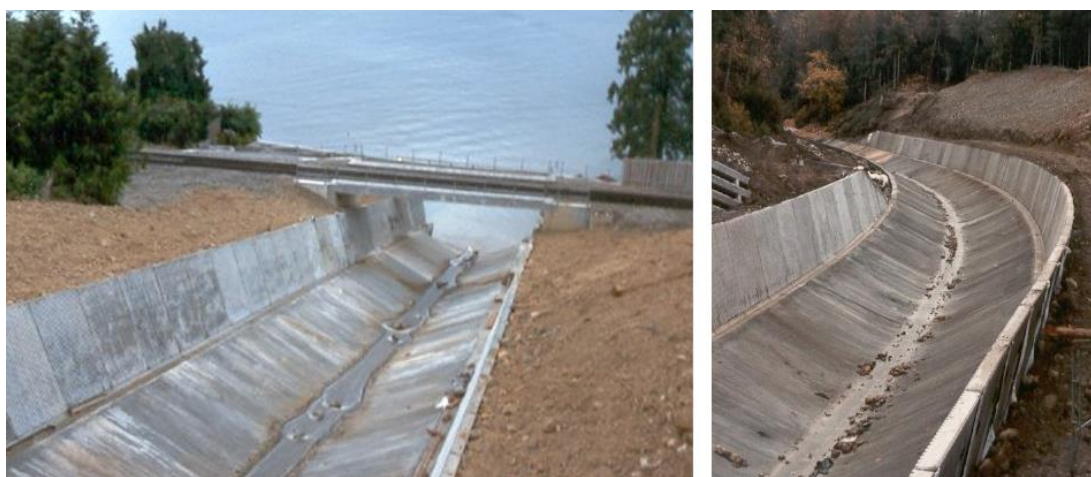
Figura 19 Canales conductores de flujos detríticos Fuente: Montserrat (2005) .
