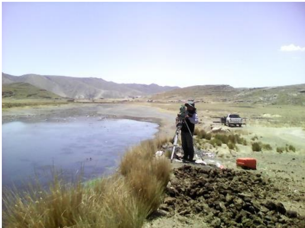
FOTO N° 12: Vista Panorámica de Progresiva 43+000 hasta 44+000 Km. en el Río Lampa ubicado en el Sector de Unocolla - Lampa. – San Roman.
