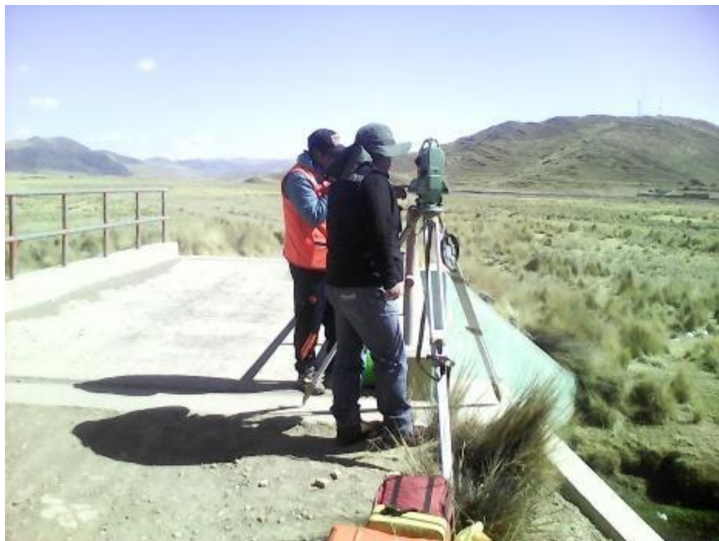
FOTO N° 08: Lectura de Relleno Topográfico desde el Punto de Control Secundario V – L5 en el Río Lampa ubicado en el Puente Moquegachi de Lampa.
