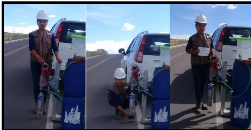
Figura 23. Fotos del instalado de la perforadora diamantina y extracción de muestra en el Km. 10+500. - MUESTRA 03: Punto de toma progresiva 16+200 (Margen Izquierdo).
