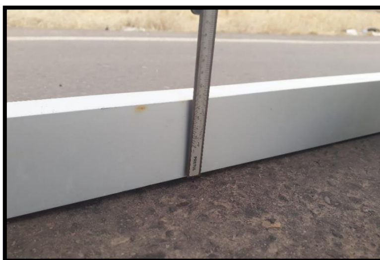
Figura 16. Foto de medida de nivel de severidad (ahuellamiento).
