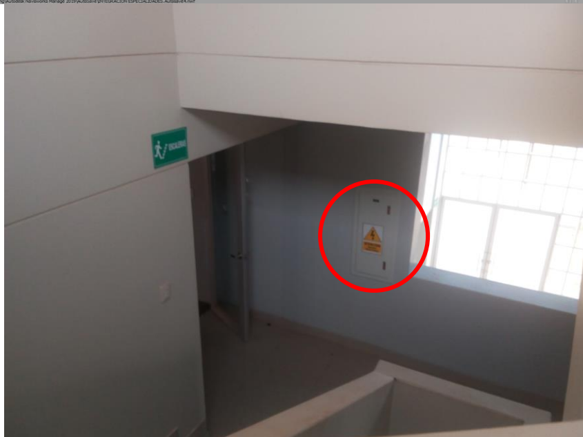
Figura N° 52: Nueva Ubicación del tablero de Distribución 2do Nivel FUENTE: Elaboración propia
