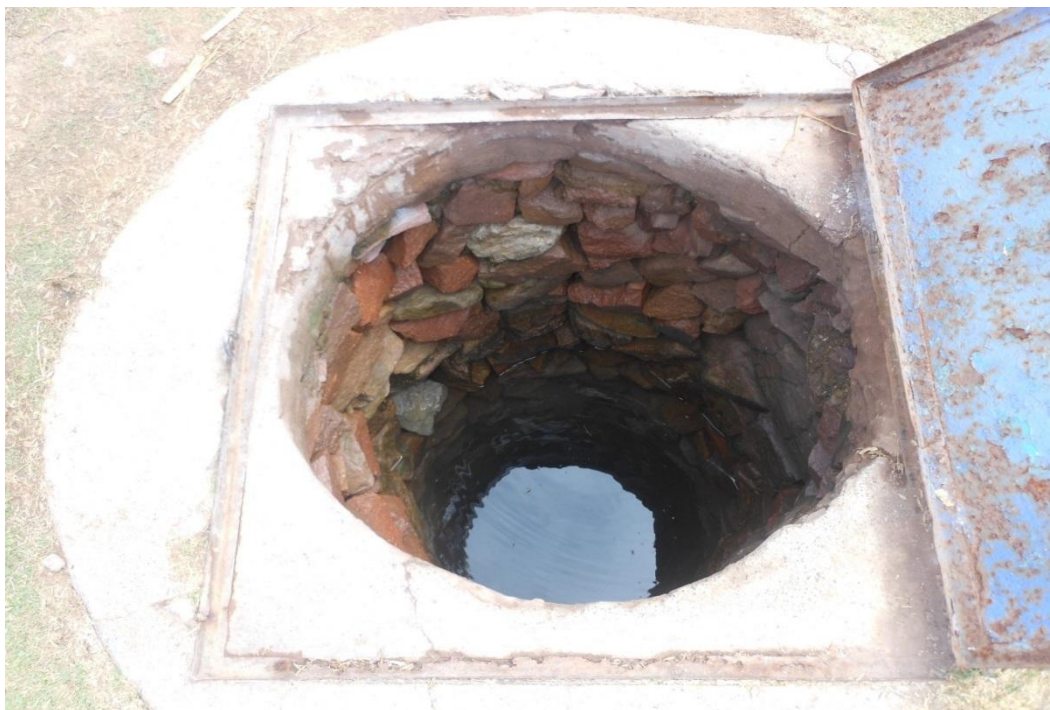
Figura 17. Pozo del cual se abastecen de agua.
