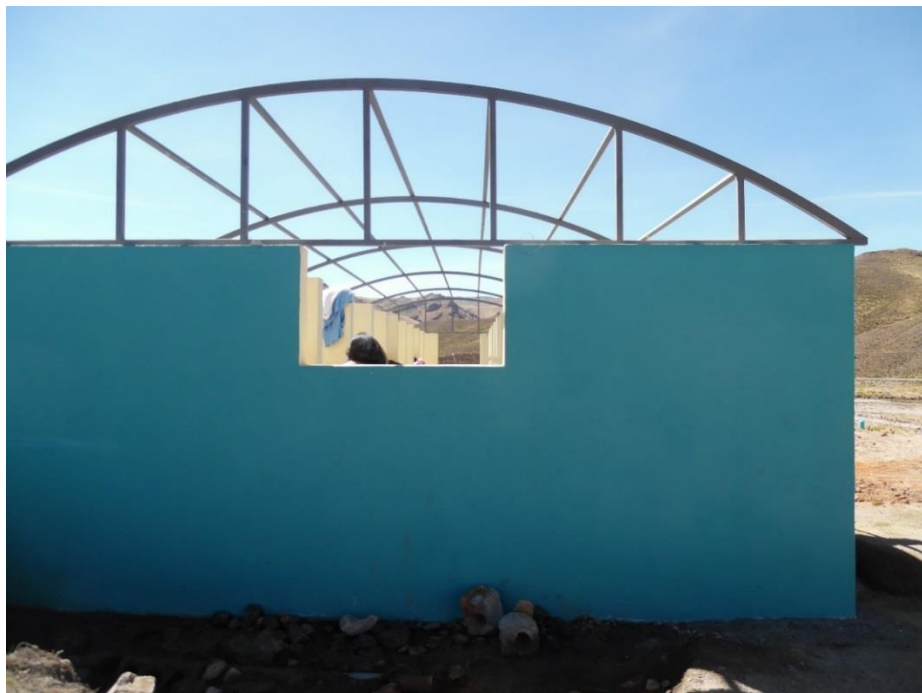
Infraestructura de las fuentes termales de Qollpa Apacheta
