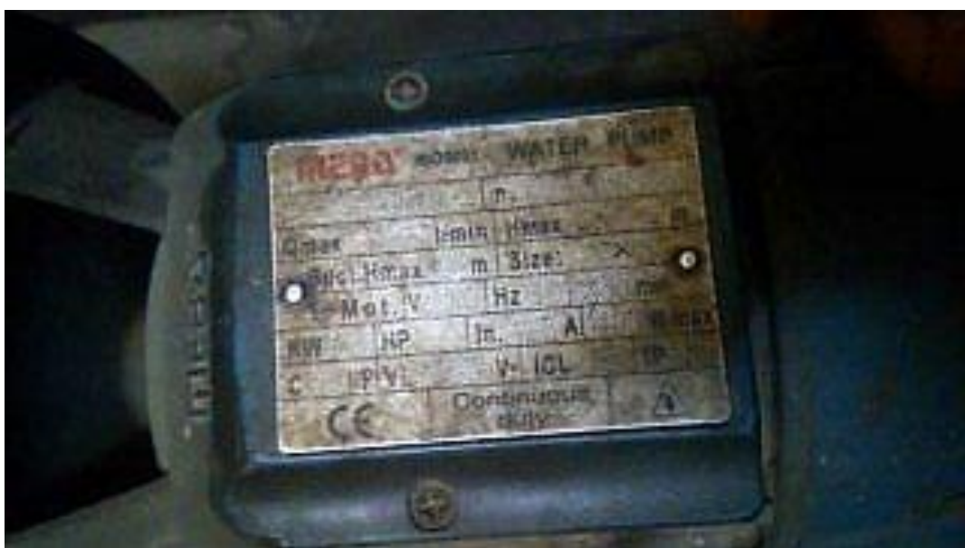
Placa de la bomba de agua.
