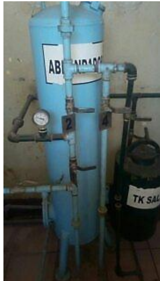
Tanques de ablandamiento
