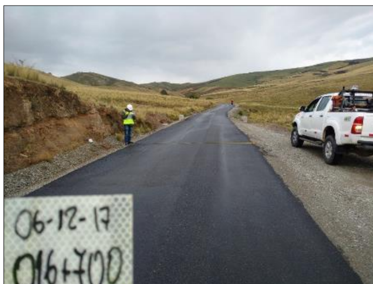
Figura 8: Tramo I - EMP 3S (Mollepuquio) – Chinchaypujio.
