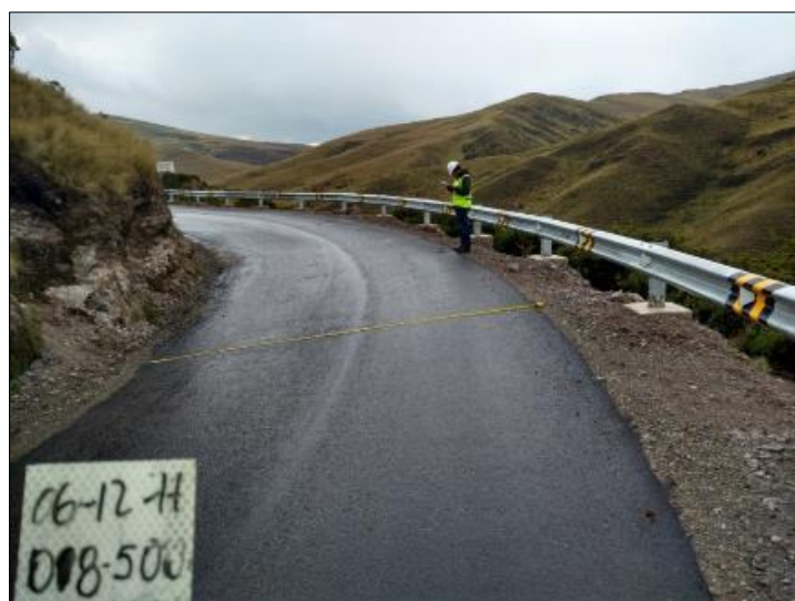
Figura 9: Tramo I - EMP 3S (Mollepuquio) – Chinchaypujio.
