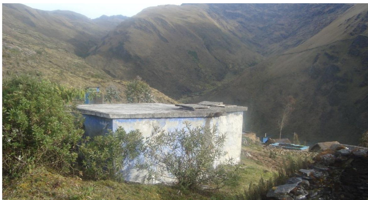
Figura N° 52: Reservorio de agua en la C.C. de Phusca
