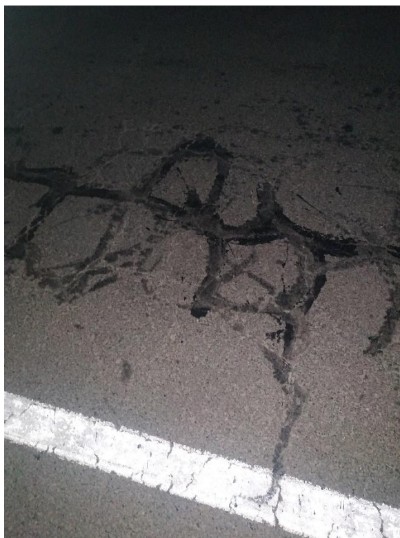
Figura 72 Relevamiento de datos en la sección de evaluación n.º 5 – fallas por fatiga selladas. Fuente: Elaboración propia
