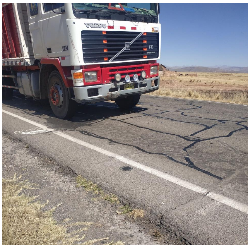
Figura 2. Trafico pesado que pasa sobre la huella de la rueda, produciendo fatigamiento.
