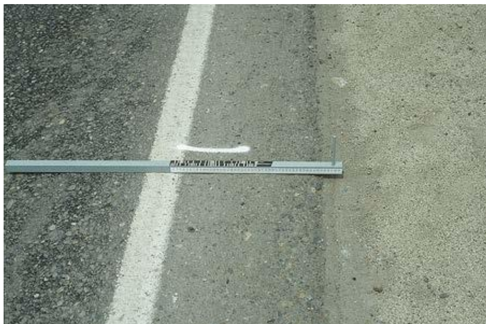
Figura 46. Tipo de falla ACP 14 – Depresión pista-berma. Fuente: DIM LTTP (2014)
