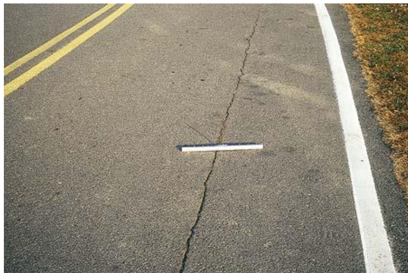
Figura 16. Tipo de falla ACP 4a – Fractura longitudinal sobre la huella de llanta. Fuente: DIM LTPP (2014).
