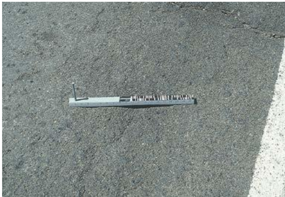
Figura 42. Tipo de falla ACP 13 – Pérdida de agregado fino. Fuente: DIM LTTP (2014).
