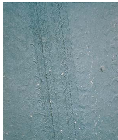
Figura 39. Tipo de falla ACP 11 – Pérdida de textura. Fuente: DIM LTPP (2014).
