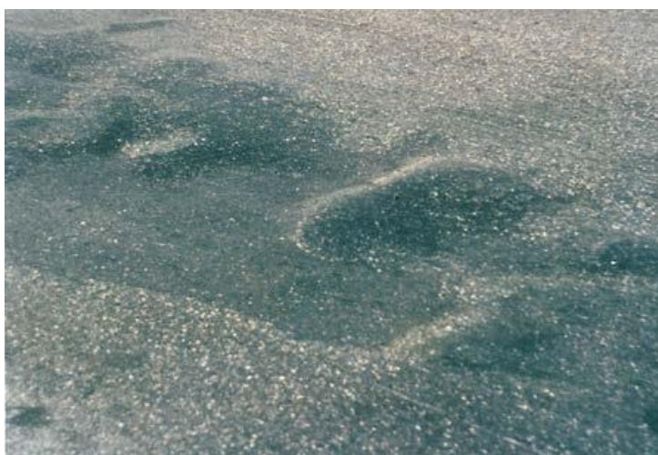
Figura 37. Tipo de falla ACP 10 – Corrimiento en superficie de pavimento. Fuente: DIM LTPP (2014).
