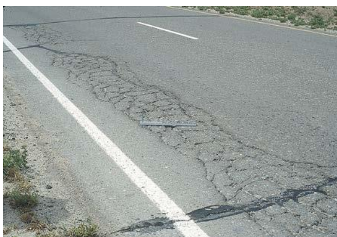
Figura 9. Tipo de falla ACP 1 – Fractura por Fatiga de moderada severidad. Fuente: DIM LTPP (2014).
