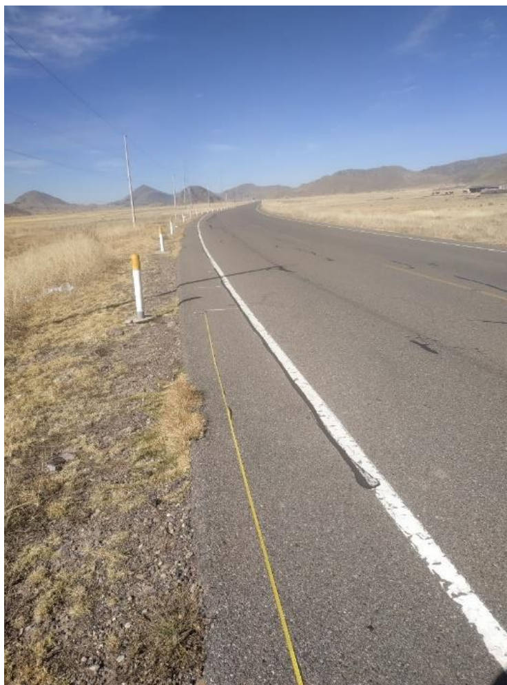
Figura 62 Relevamiento de datos en la sección de evaluación n.º 2 – fallas longitudinales en la huella de rueda. Fuente: Elaboración propia
