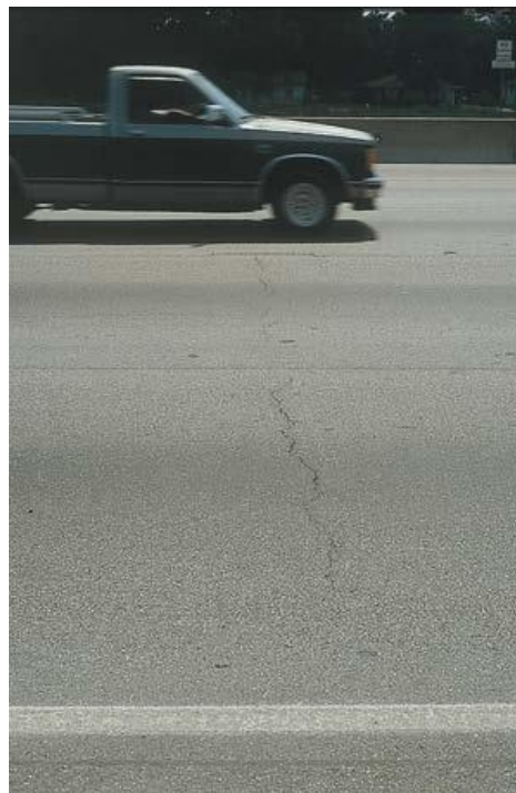
Figura 21. Tipo de falla ACP 6 – Fractura transversal de severidad baja. Fuente: DIM LTPP (2014).
