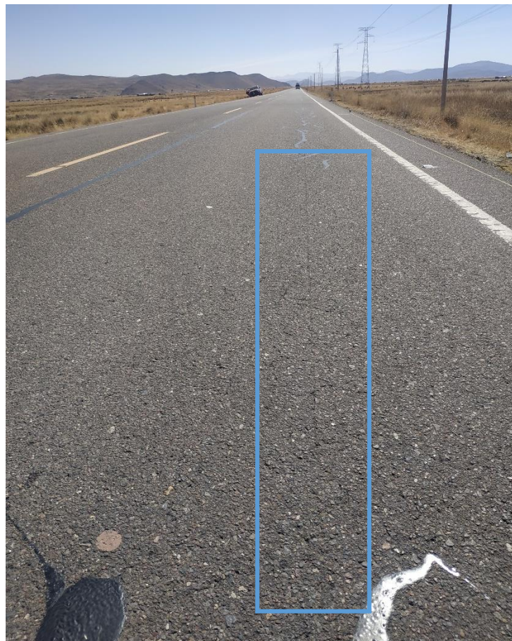
Figura 4. Marca de construcción en la carpeta, que posteriormente se convierte en falla longitudinal.
