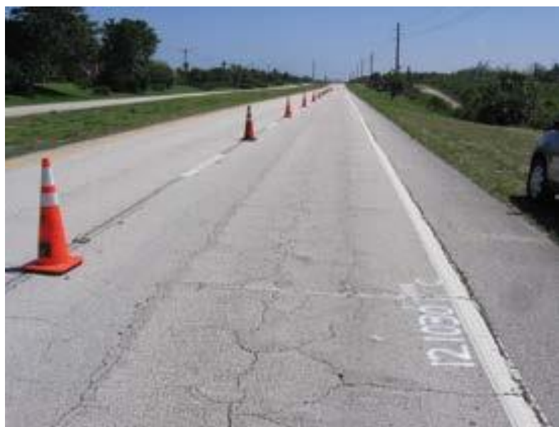
Figura 12. Tipo de falla ACP 2 – Fractura en bloque con fractura por fatiga en la huella de llanta. Fuente: DIM LTPP (2014).
