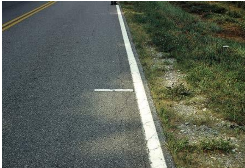
Figura 14. Tipo de falla ACP 3 – Fractura de borde de baja severidad. Fuente: DIM LTTP (2014).
