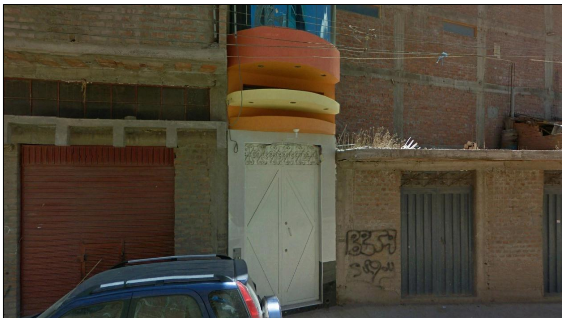
Figura 11: Frentera de vivienda antirreglamentaria.
