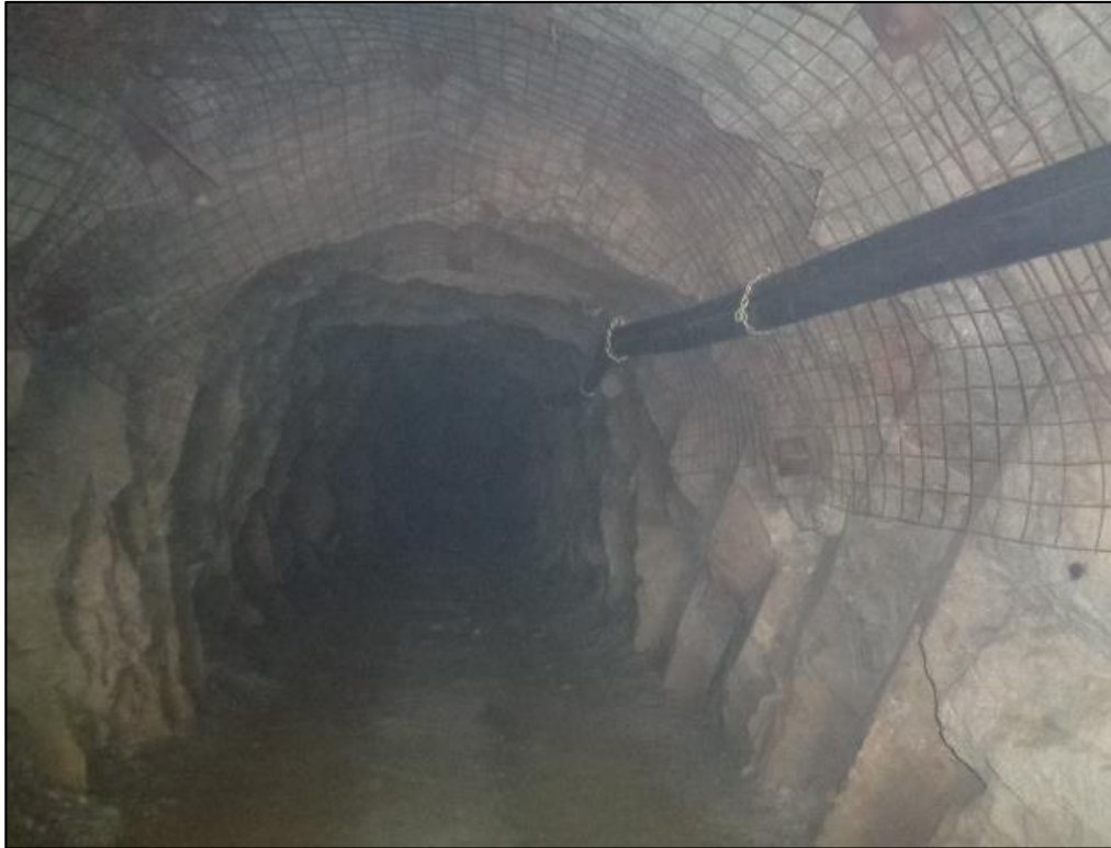
Figura 12: Galería de acceso del nivel 1849, con medidas de sostenimiento convencional con malla electrosoldada y Split set de 5 pies.
