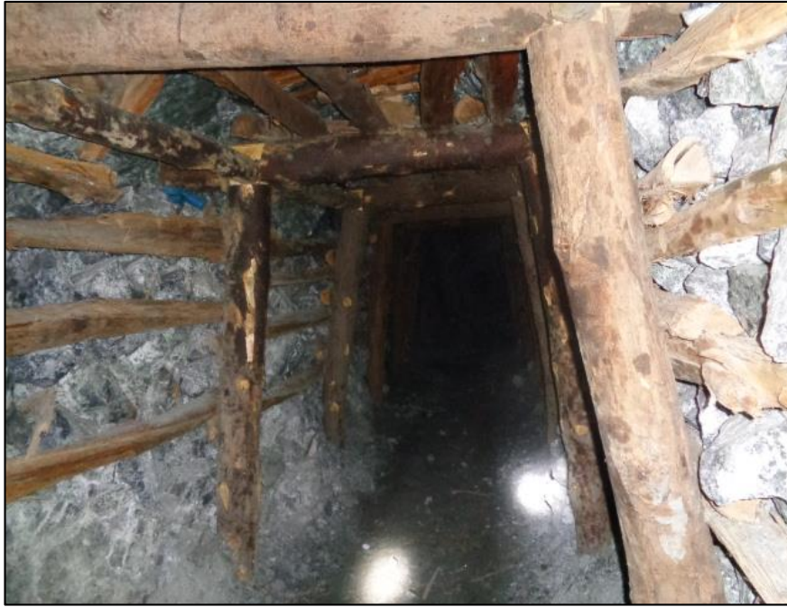
Figura 14: Instalación de cuadros cónicos de madera, espaciados a cada 1.5 metros, en roca de tipo IV-A.
