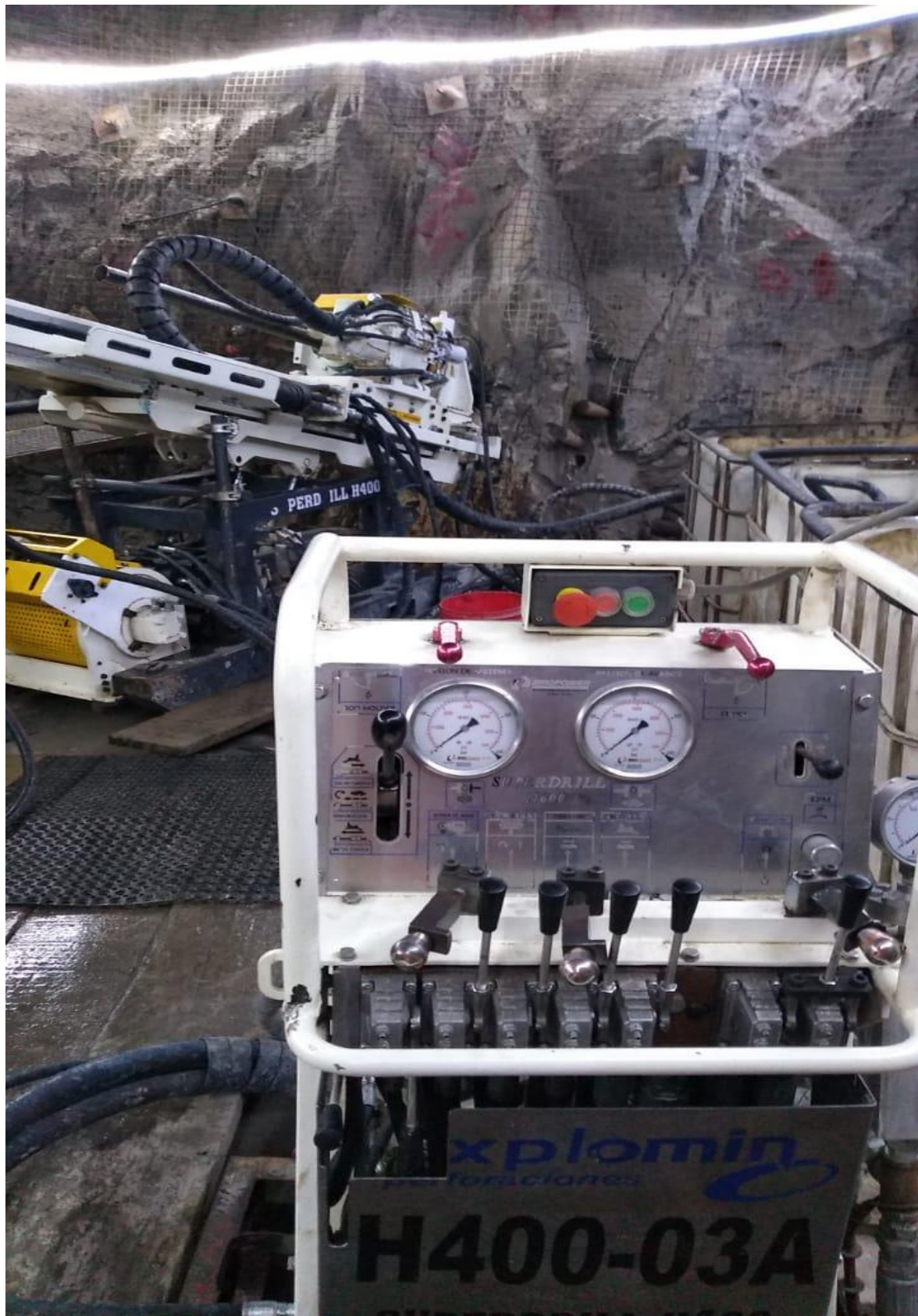
Figura 2.5: Tablero del mando de la máquina perforadora Fuente: Contrata Minera Explomin del Perú S.A.
