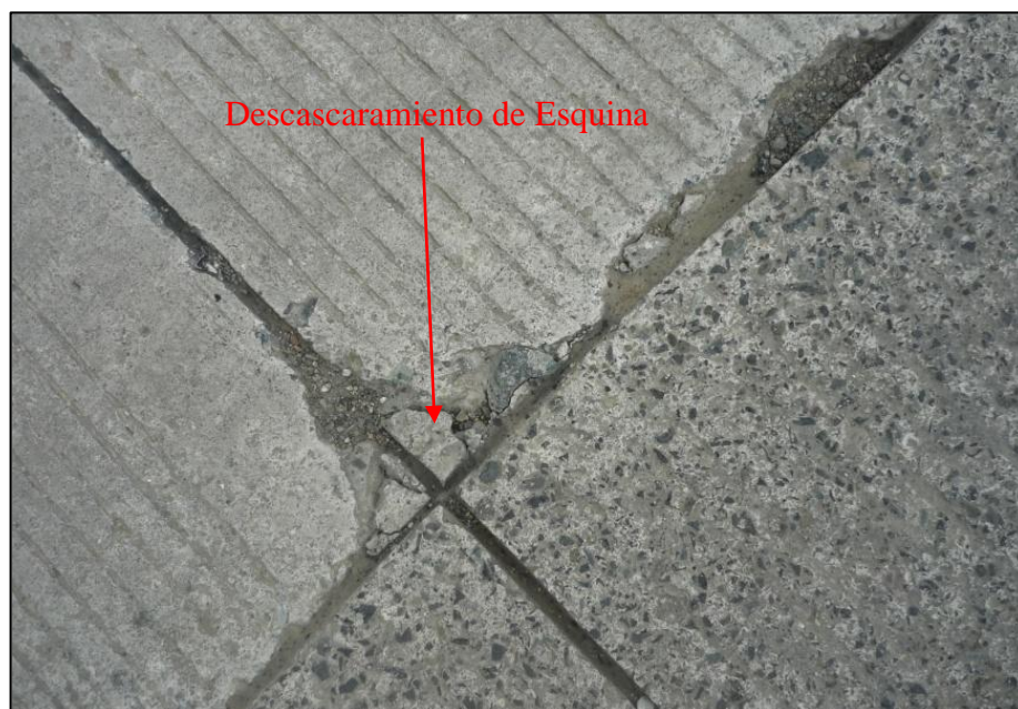
Figura. 44 Descascaramiento de esquina (Despostillamientos) FUENTE: (Ruiz Brito, 2011)
