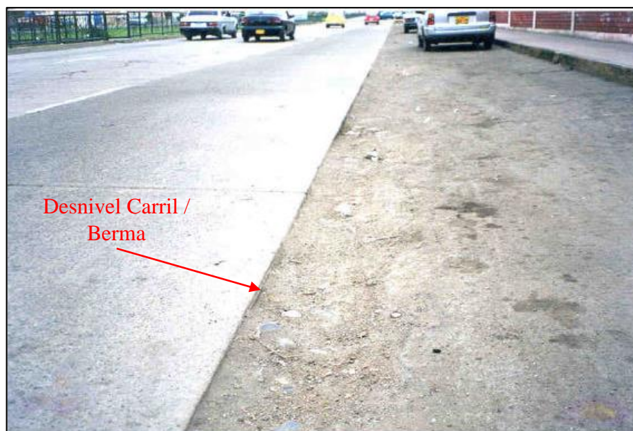
Figura. 33 Desnivel Carril/ Berma FUENTE: (Hamilton et al., 1999)
