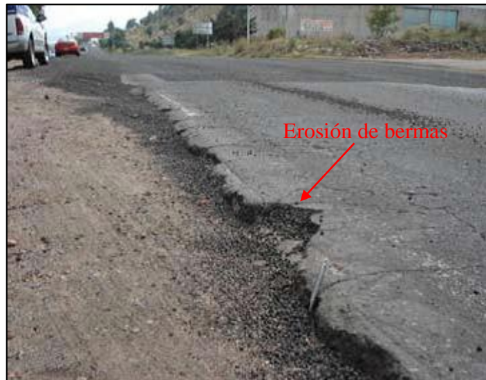
Figura. 26 Erosión de bermas FUENTE: (Instituto Nacional de Vías, 2008)
