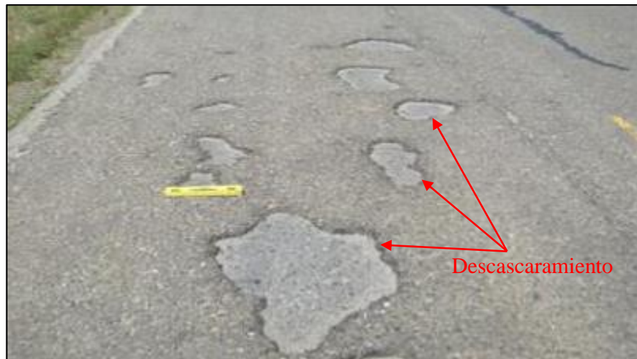
Figura. 23 Descascaramiento FUENTE: (Instituto Nacional de Vías, 2008)
