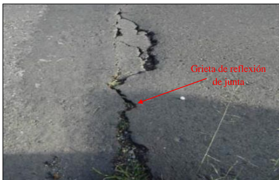
Figura. 11 Grieta de Reflexión de Junta.
