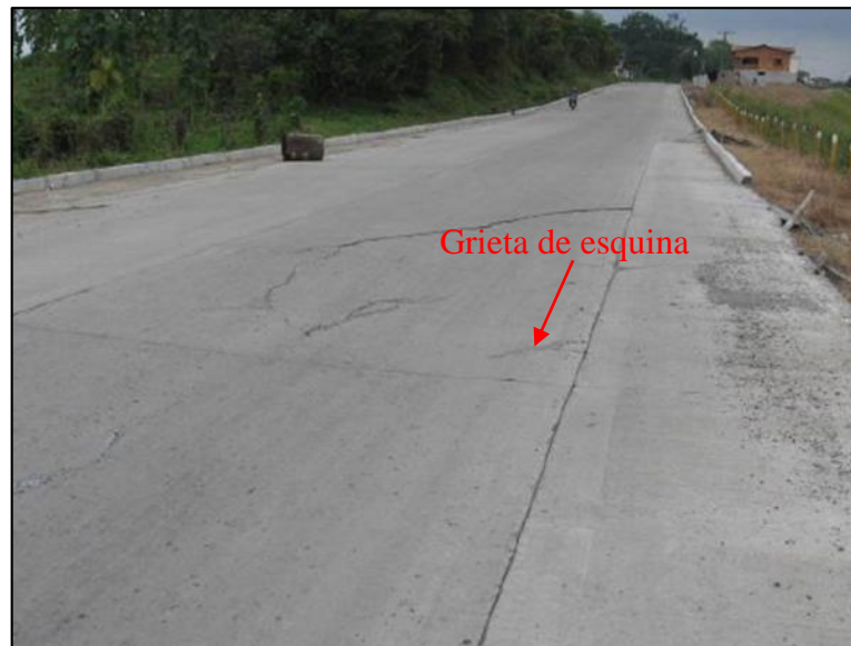
Figura. 28 Grieta de esquina FUENTE: (Ruiz Brito, 2011)
