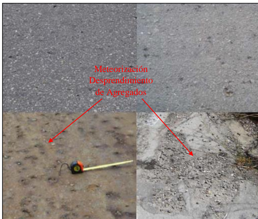
Figura. 22 Meteorización / desprendimiento de agregados FUENTE: (Universidad Nacional de Colombia & Instituto Nacional de Vías, 2006)
