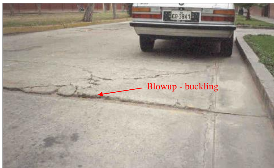
Figura. 27 BLOWUP – BUCKLING FUENTE: (Hamilton et al., 1999)
