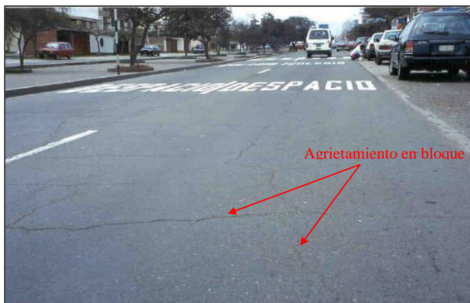
Figura. 6 Agrietamiento en bloque.
