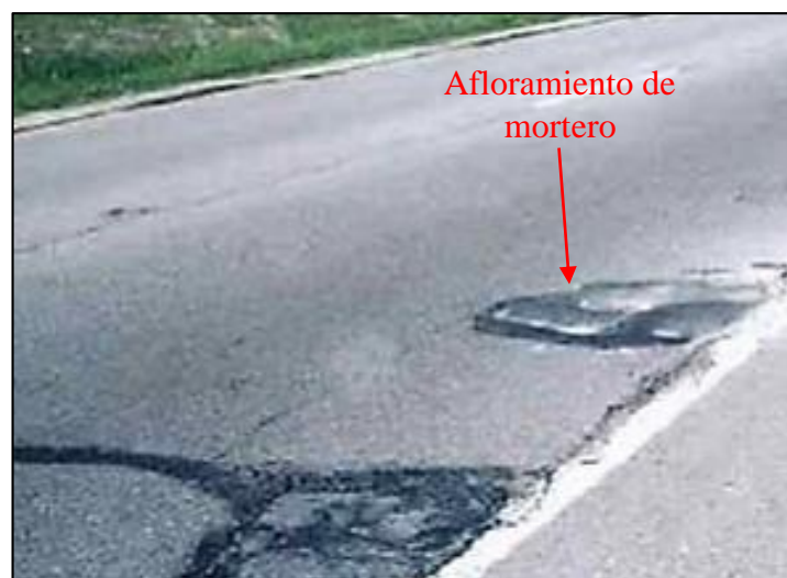
Figura. 24 Afloramiento de mortero FUENTE: (Instituto Nacional de Vías, 2008)
