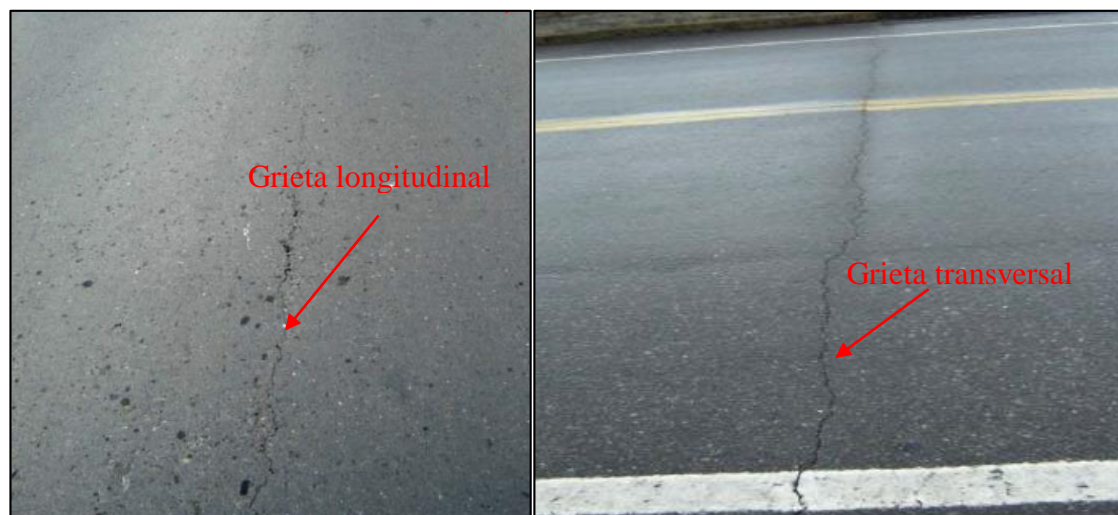
Figura. 13 Grietas longitudinales y transversales.
