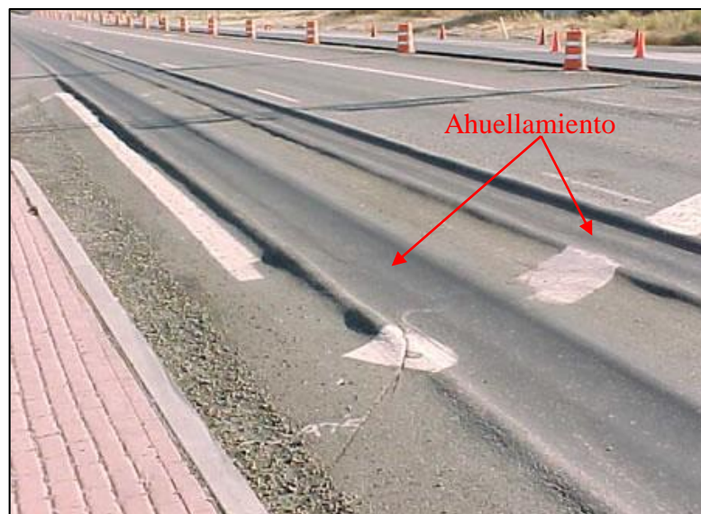
Figura. 18 Ahuellamiento. FUENTE: (Corros et al., 2009)
