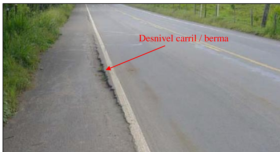
Figura. 12 Desnivel carril / berma.
