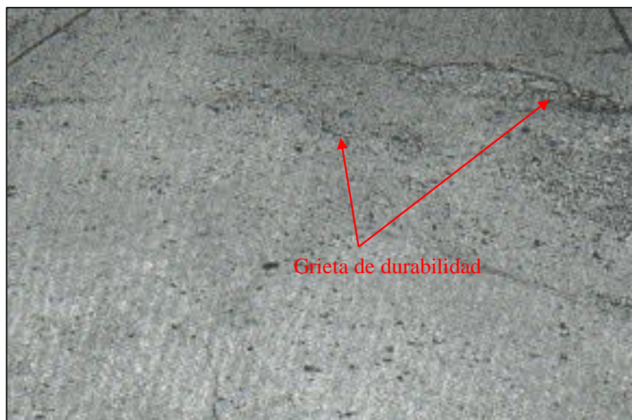
Figura. 30 Grieta de durabilidad FUENTE: (Vásquez, 2002)
