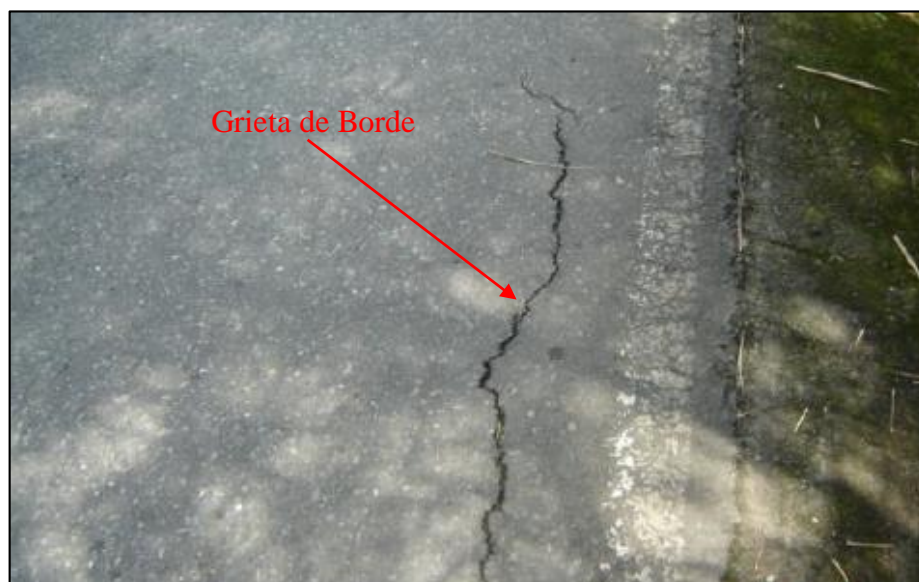
Figura. 10 Grieta de Borde.
