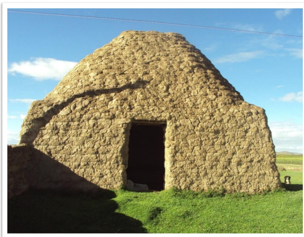
Putuco contruidos con c'hampa, que se encuentran en abandono y con daños estructurales que fueron generados por las precipitaciones pluviales, causando erosión y deformación de los muros.
