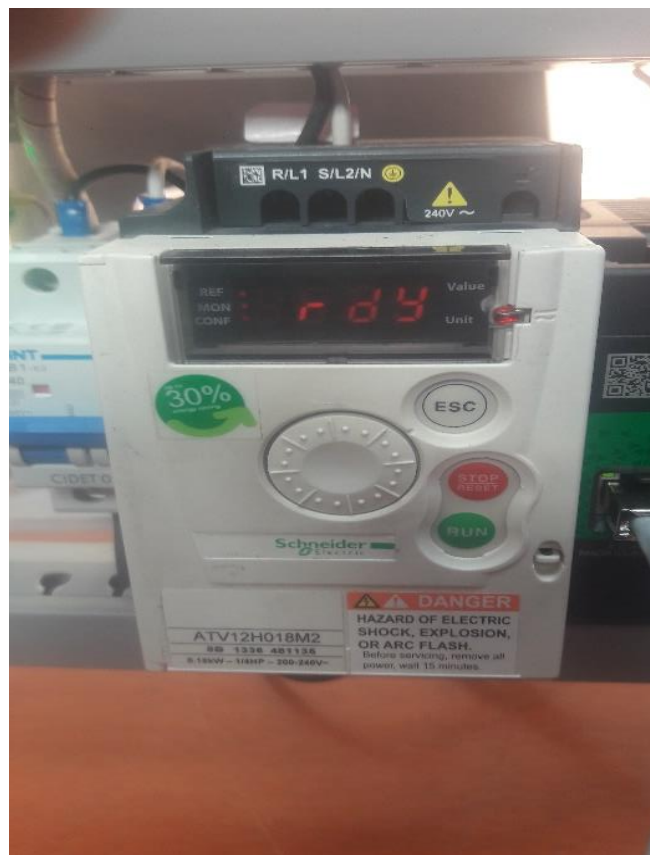
Figura 4.31. Variador de frecuencia
