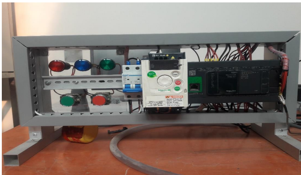
Figura 4.33. Sistema de mando, señalización pulsadores y todo el control
