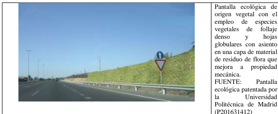
Figura 156: Barrera acústica en infraestructura: Pantalla Vegetal.
