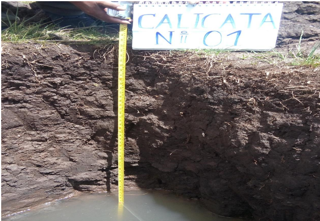
FOTO. N° 01: VISTA DE EXCAVACIÓN CALICATA N° 01 DEL SUELO DE FUNDACIÓN CON RETROEXCAVADORA, NIVEL FREÁTICO.
