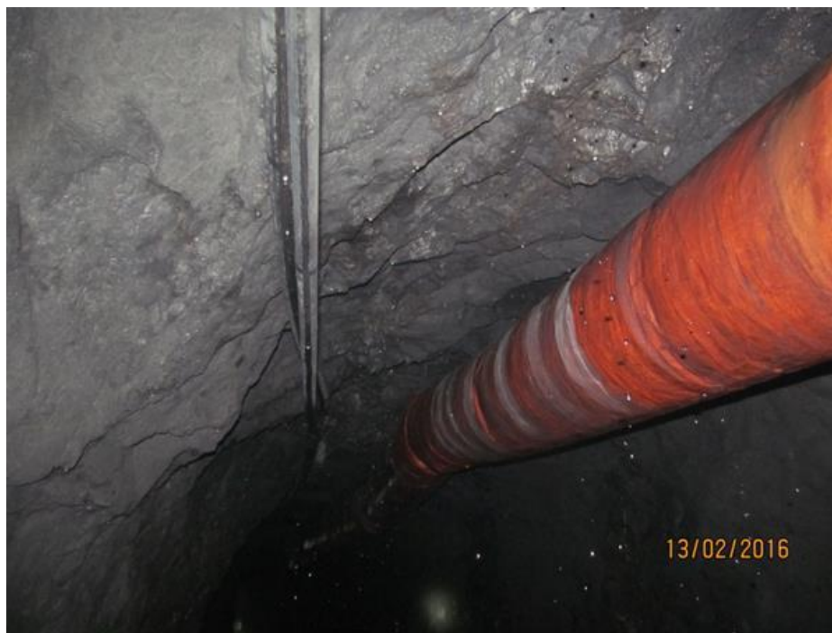
Figura 6: Observacion goteras en la labor
