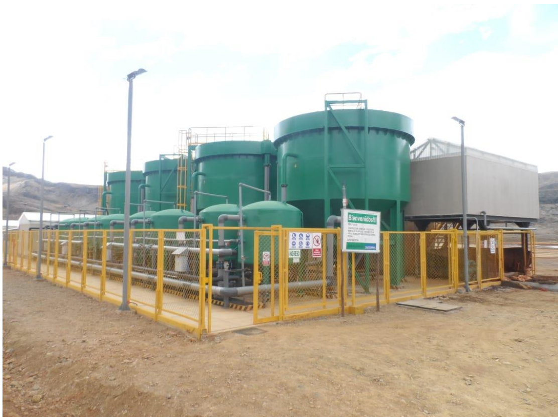
Fotografía 5. Planta De Tratamiento (Ptar)
