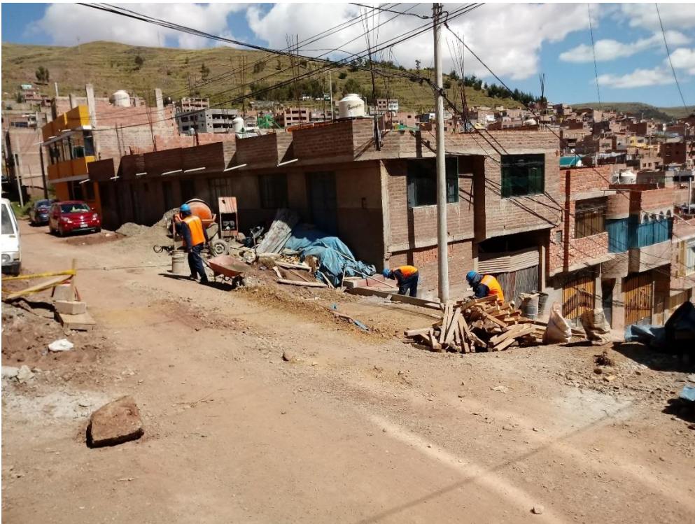
Fotografía 2: Se observa el vaciado de concreto y acabado de cuneta. Encofrado de losa
