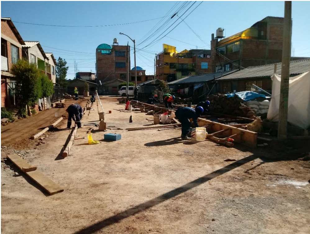
Fotografía 7: Se observa encofrado de sardinel, acabado de veredas y afirmado en vereda.
