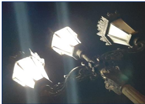
Figura 53: Luminarias actuales instaladas en el parque. Elaboración Propia
