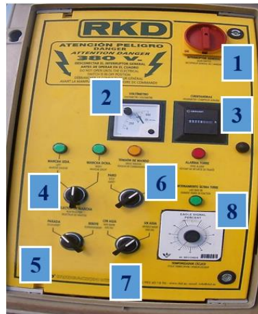
Figura 6: Tablero de control del sistema
