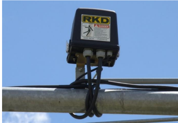
Figura 3: Caja de control de torre
