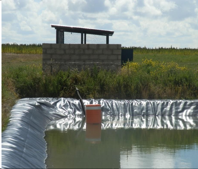
Cabezal de riego y reservorio de geomembrana del sistema de riego
