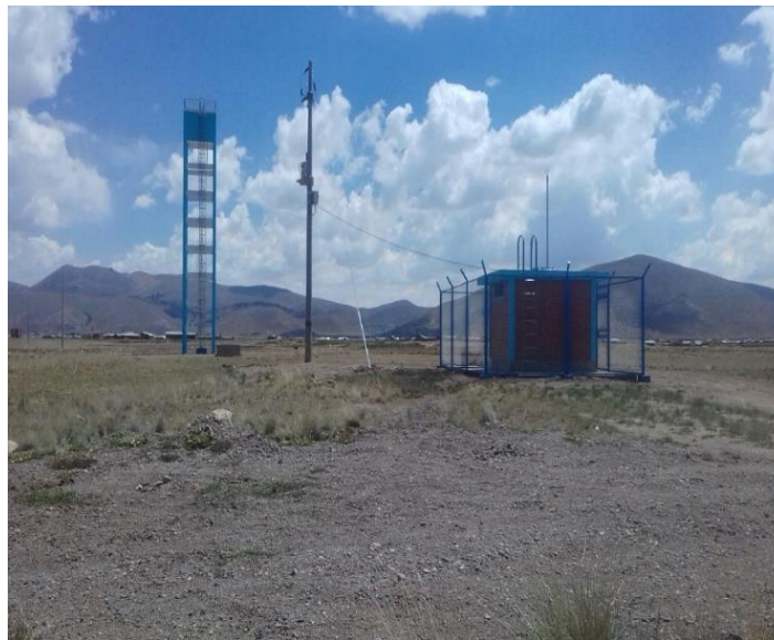
Figura A.6: De Nora Chipana. (C.P. de Caritamaya 2018). En la fotografía se observa las instalaciones de control y mantenimiento de aguas tratadas en 3 sectores.
