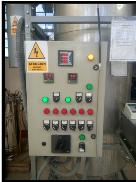
Figura C.10: Inicio de la operación de secado por atomización (tablero de control del equipo).
