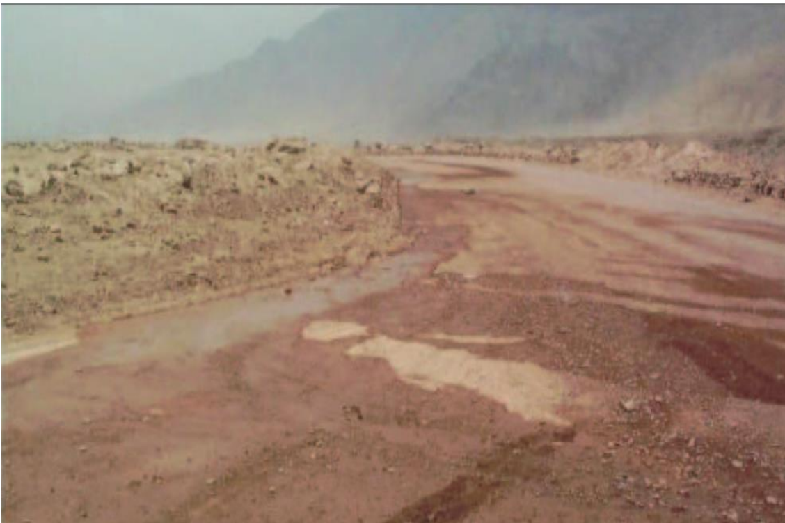
Figura 12: Gravedad 2: Necesita Una Capa de Material Adicional.
