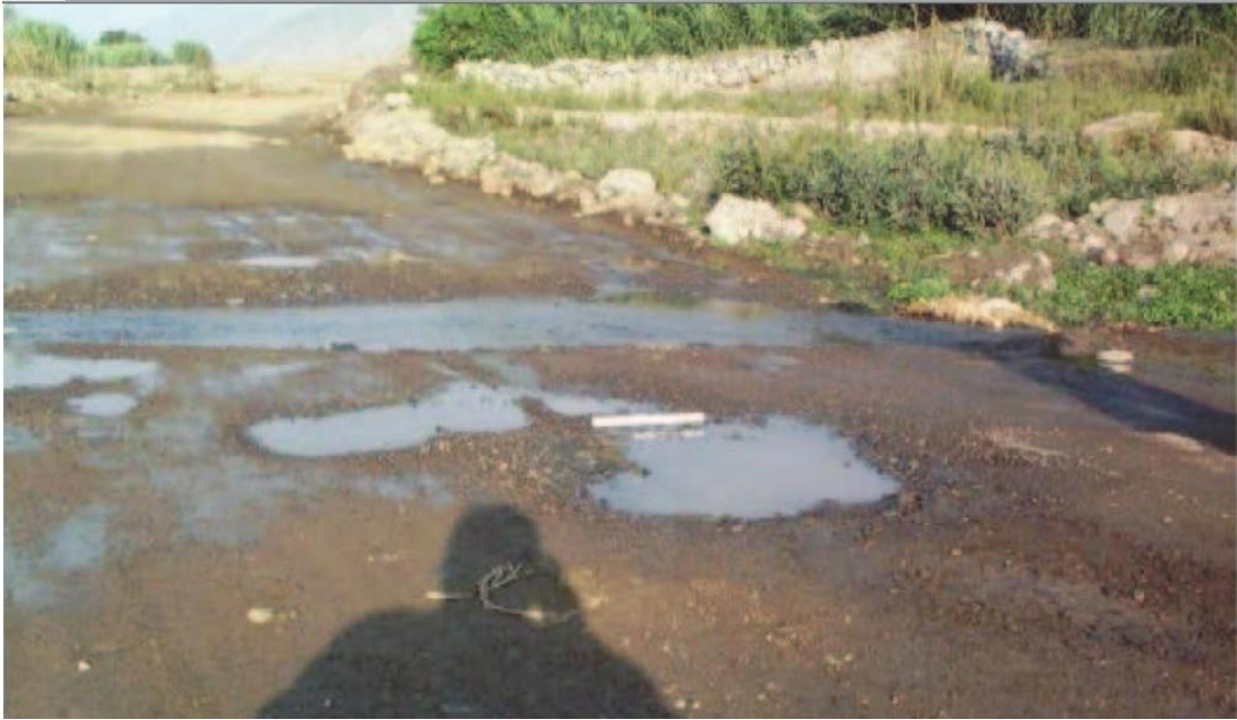
Figura 13: Necesita una reconstrucción.
