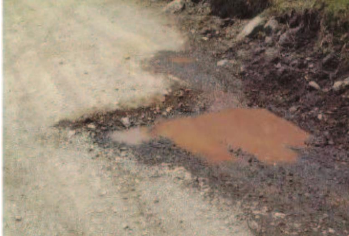
Figura 11: Gravedad 1: Pueden Repararse por Mantenimiento Rutinario.
