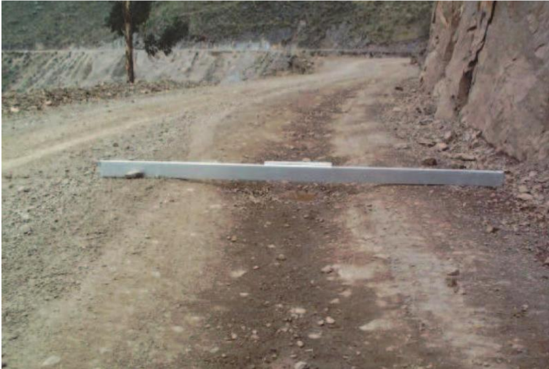
Figura 7: Gravedad 3: Huellas/Hundimientos \geq 10 cm.
