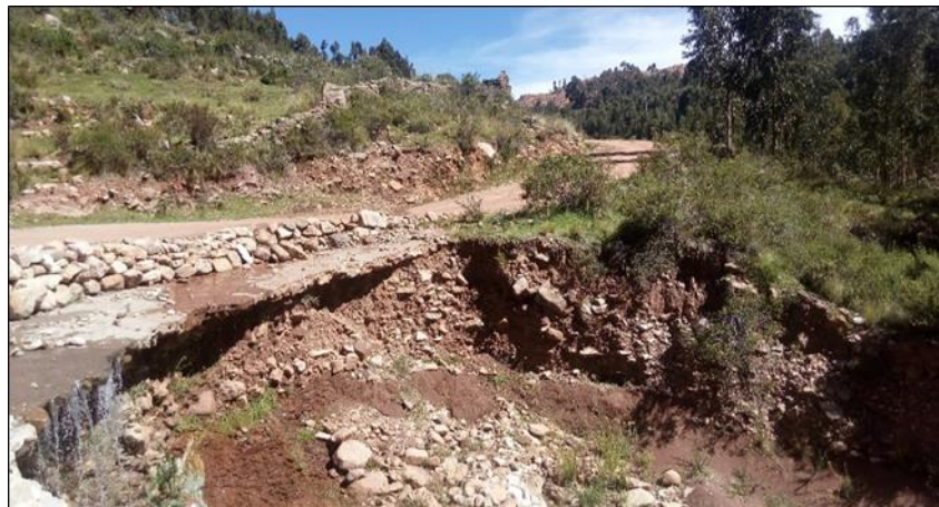
Figura N° 4: Carretera PU-147, mal estado.
