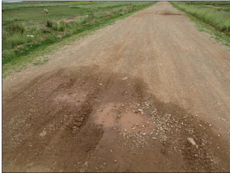
Figura N° 1: Carretera PU-140, mal estado.
