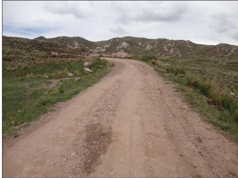
Figura N° 3: Carretera PU-150, mal estado.
