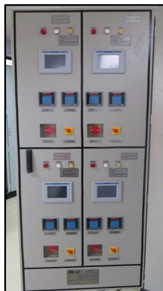
Figura 26: Caja o tablero de control del SPCI
