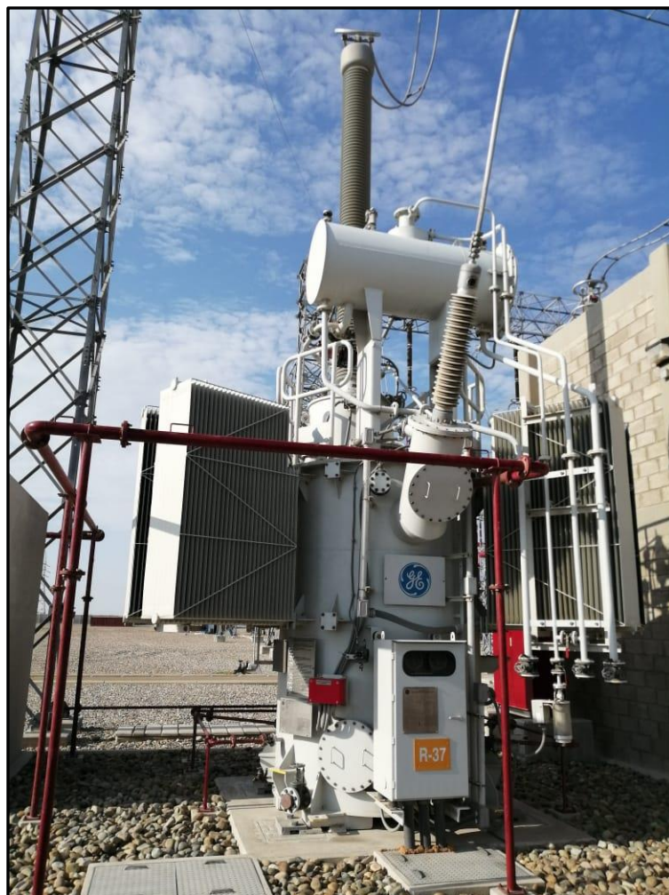
Figura 13: Reactor monofásico de potencia en 500 kV
