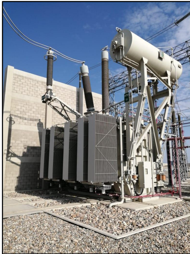
Figura 1: Autotransformador de potencia en 500 kV
