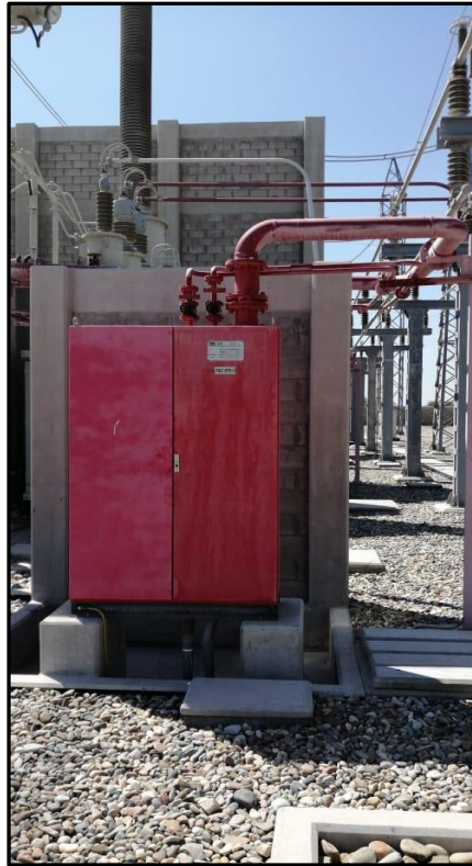
Figura 35: Armario de extinción de incendios F.E.C. del SPCI
