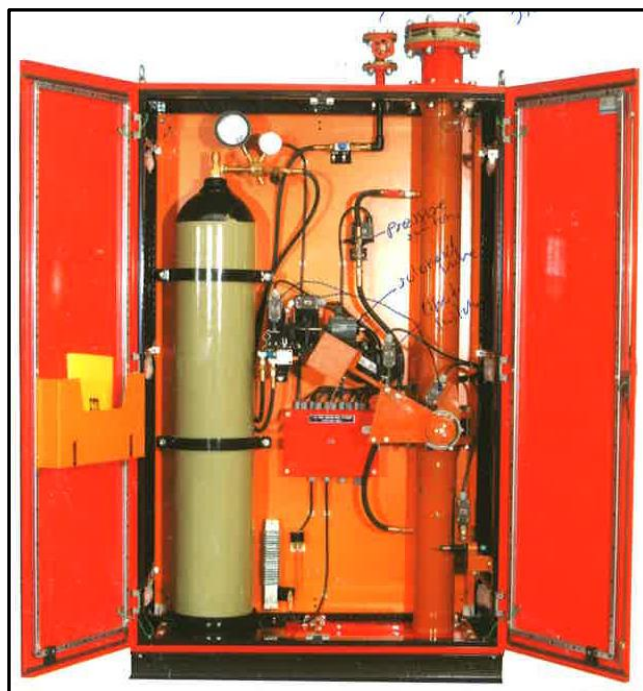
Figura 39: Accionamiento electromecánico del armario contra incendio del SPCI
