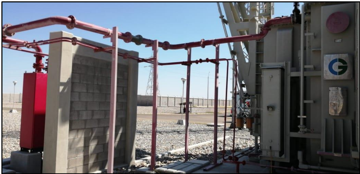
Figura 37: Conexión de tuberías de drenaje de aceite del SPCI
