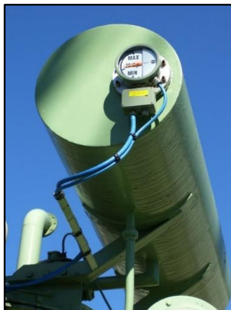
Figura 5: Conservador de autotransformador de potencia en 500 kV
