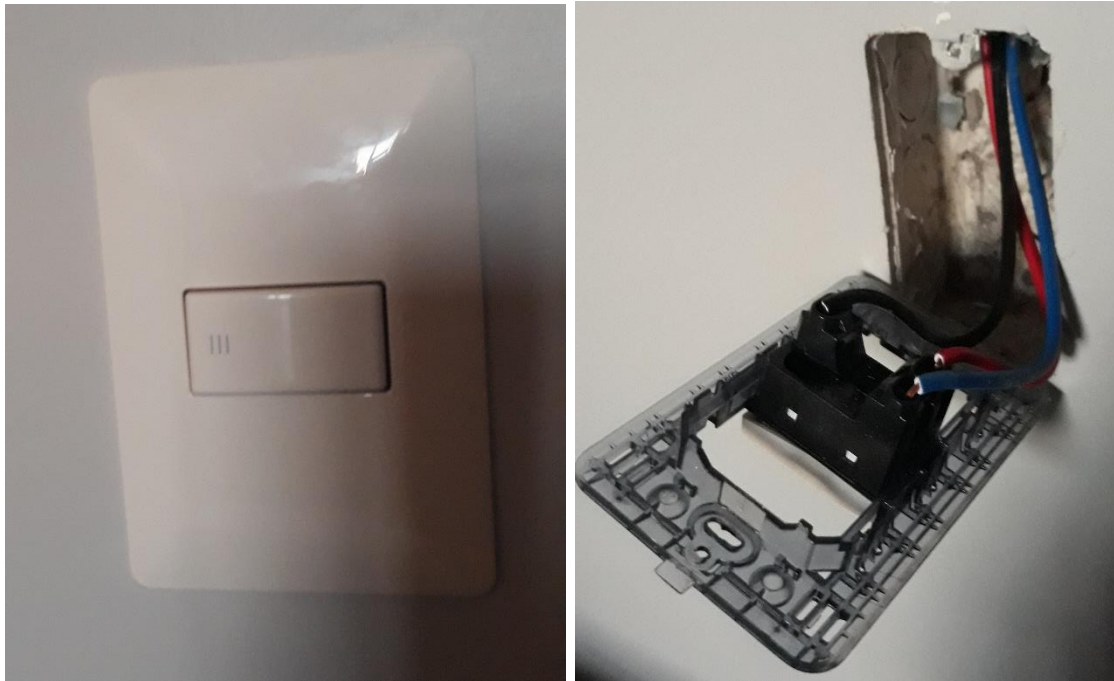
Figura N° 10: Interruptor de conmutación.
