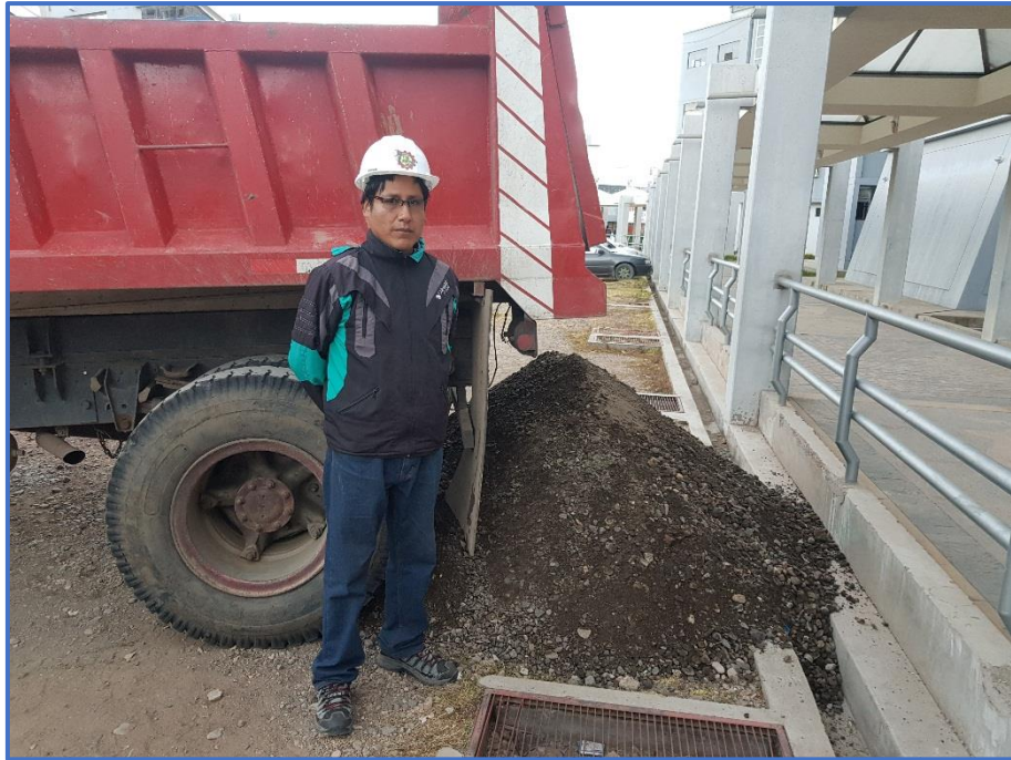
Figura A. 5 Entrega del agregado global (hormigón) de la cantera de Viluyo – Laraqueri.
