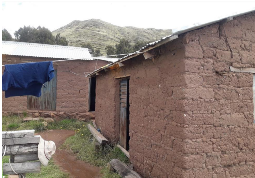
Figura 76. Fotografía estado actual de los pisos en las viviendas del centro Poblado de Yapura
