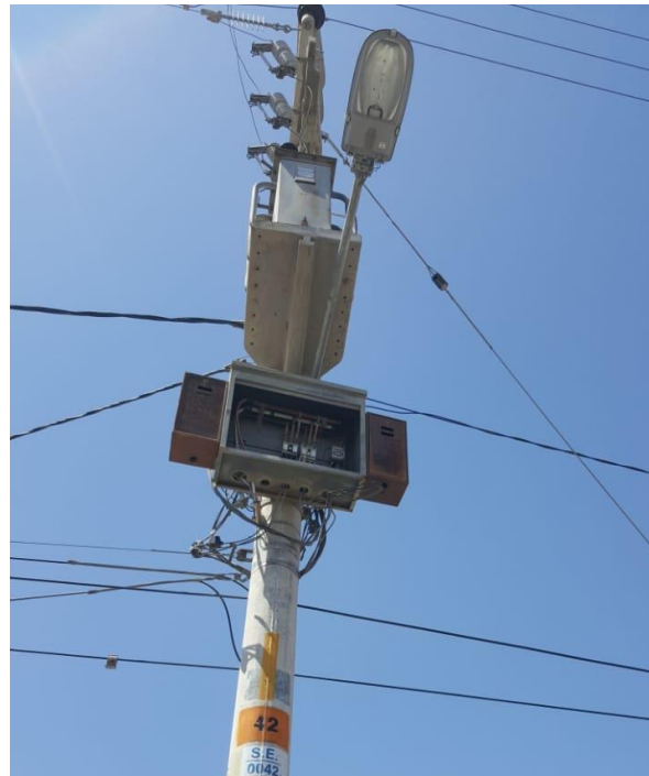
Figura N° 12: .S.E. 41 Con pérdida de la función
