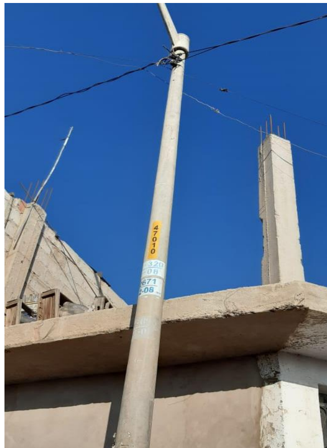
Figura N° 14: Estado de las estructuras
