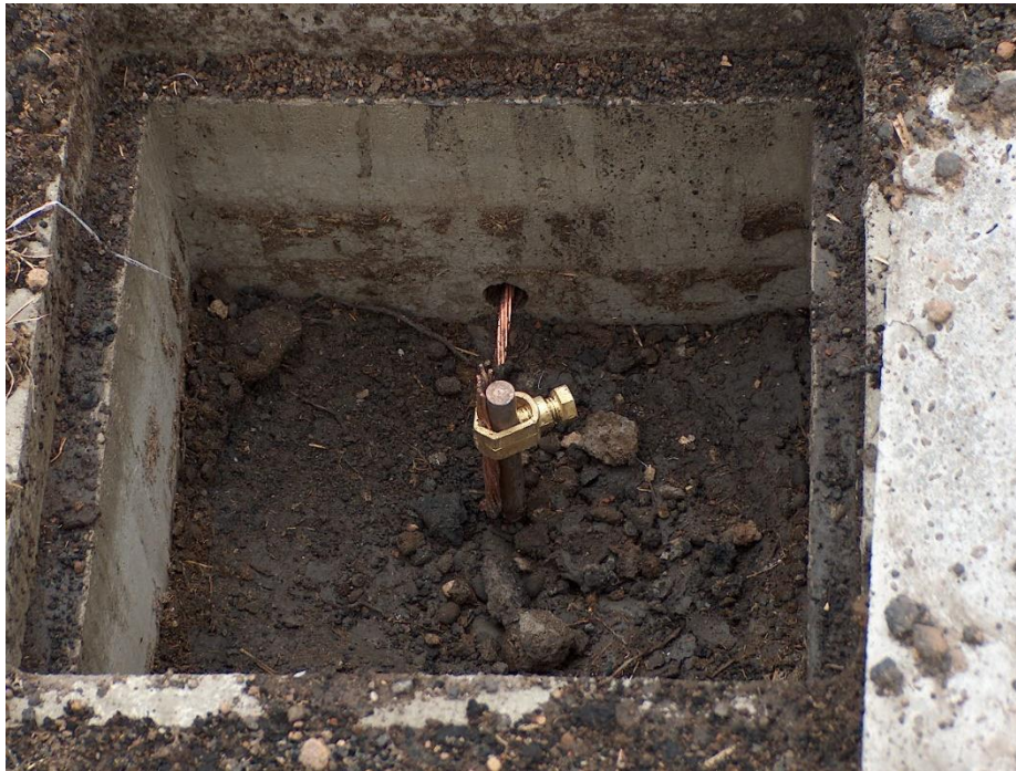
Figura N° 6: Pozo a tierra.
