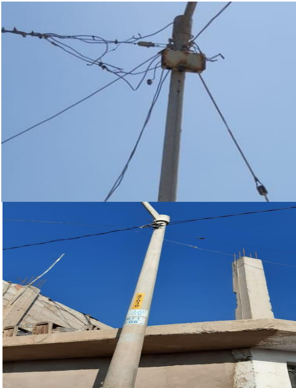
Figura N°23: Estado de los equipos de medición Elaboración propia
