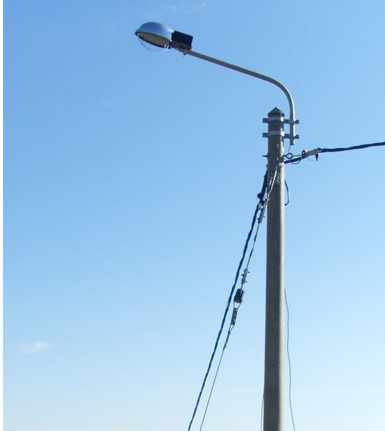
Figura N° 4: Luminaria A.P. Elaboración propia
