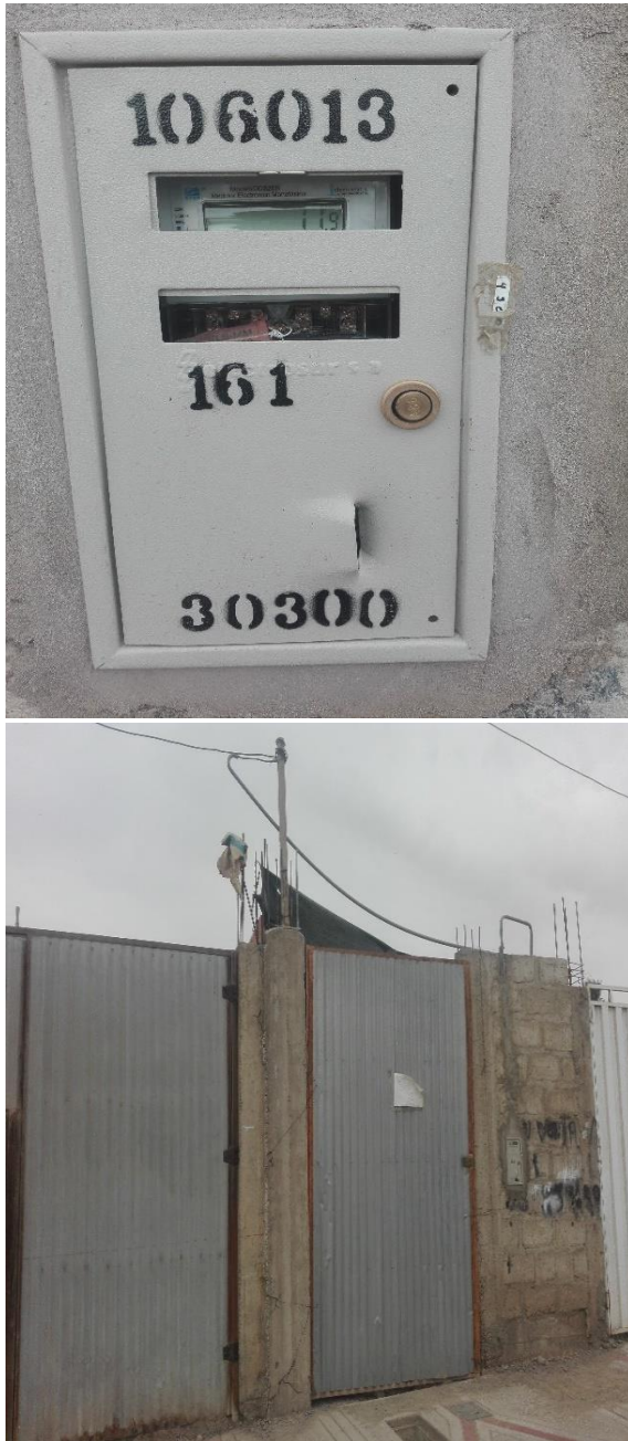
Figura N°20: Estado de los equipos de medición Elaboración propia.
