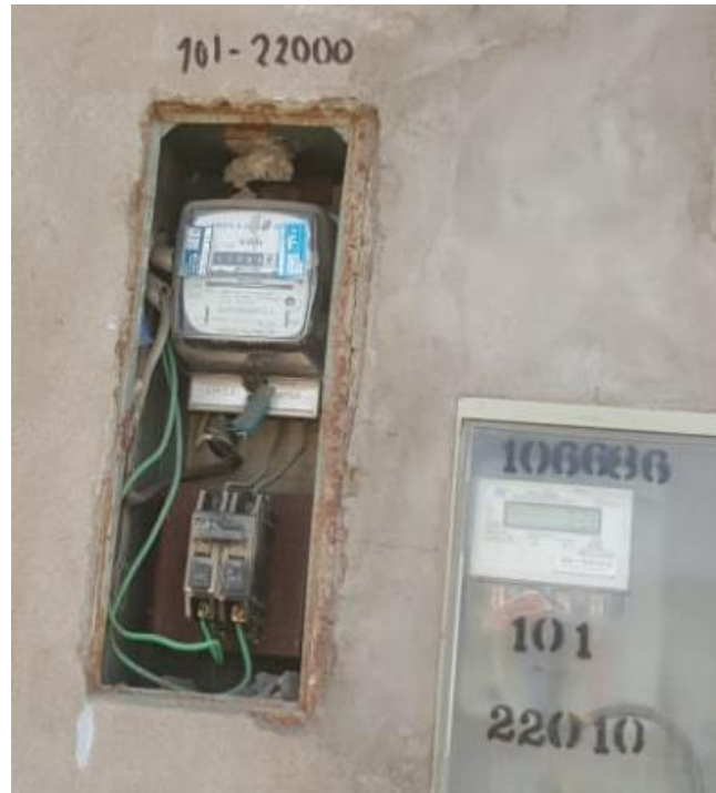
Figura N° 5: Contador de energía. Elaboración propia
