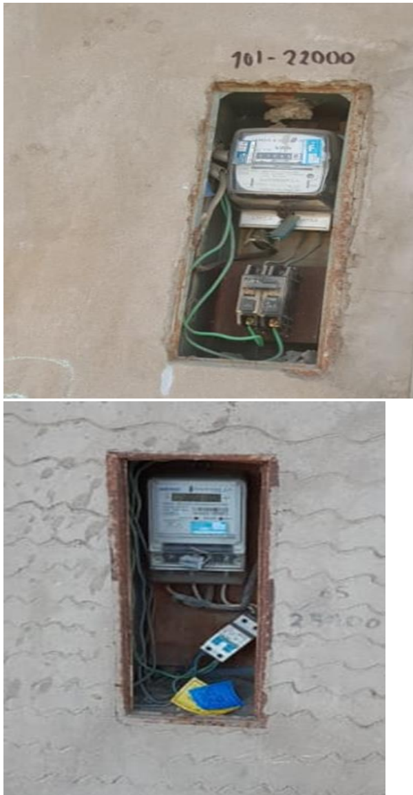
Figura N°22: Estado de los equipos de medición Elaboración propia
