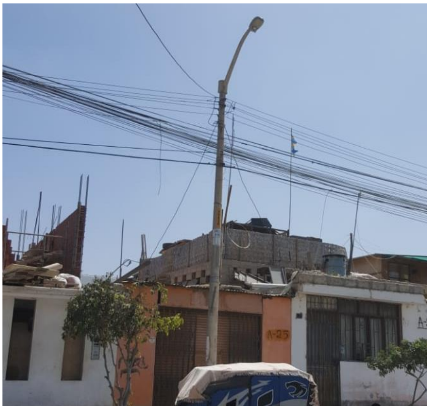
Figura N° 13: Estado de los conductores
