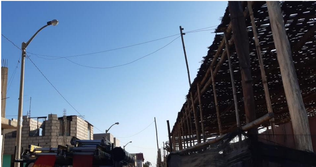
Figura N° 3: Conductores y acometidas R.S.
