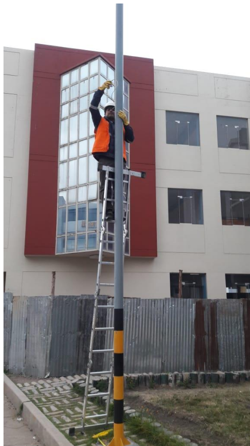
Figura N° 24: Instalación del sensor de presencia en un poste de alumbrado. Elaboración propia.
