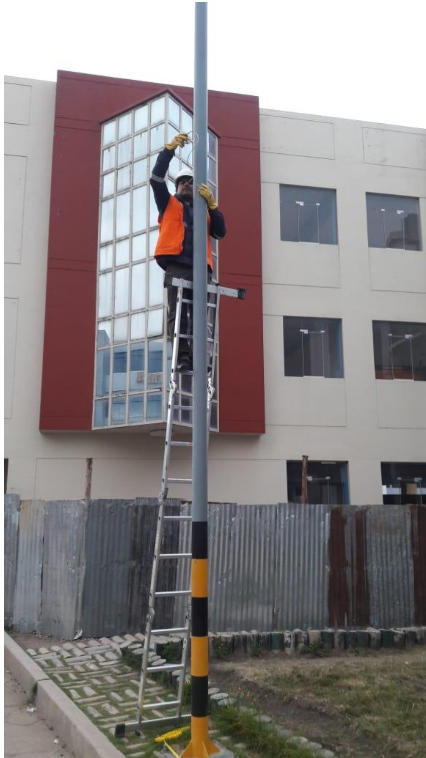
Figura N° 54: Instalación del sensor de presencia a 6.6 metros sobre el nivel del suelo. Elaboración propia.
