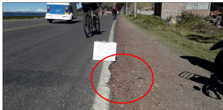
Figura N° 43: Borde de calzada en mal estado progresiva 1367+600 curva CH-05
