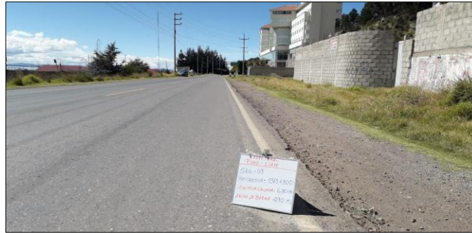
Figura N° 42: Berma sin pavimentar progresiva 1365+300
