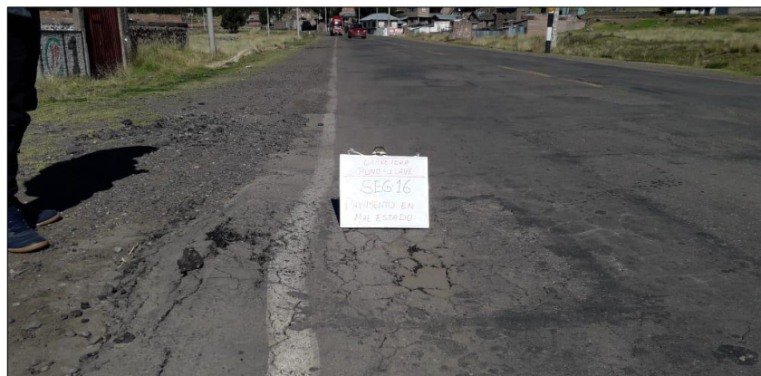
Figura N° 45: Deformaciones en el pavimento progresiva 1372+700
