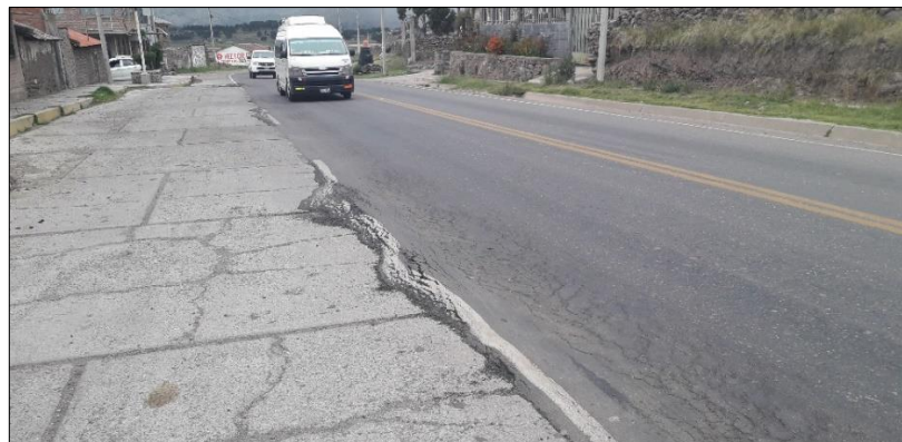
Figura N° 39: Ahuellamiento en el pavimento progresiva: 1377+500
