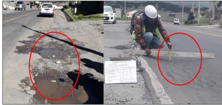
Figura N° 46: Pavimento y berma en mal estado progresiva 1377+400
