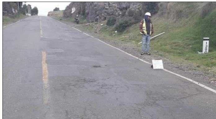
Figura N° 47: Presencia de parches en la calzada progresiva 1380+000
