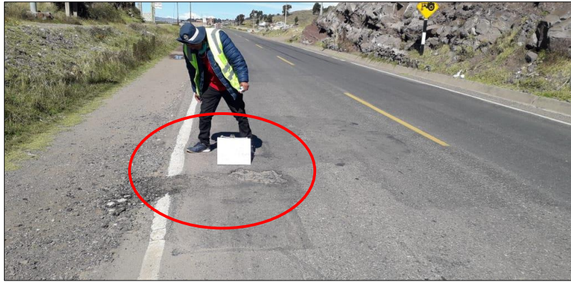
Figura N° 44: Baches en el pavimento progresiva 1370+500
