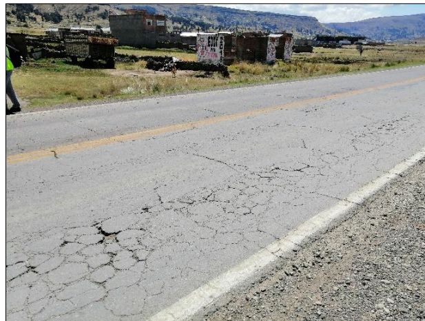
Figura N° 7: Pavimentos Asfáltico En Mal Estado
