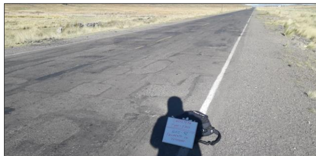
Figura N° 49: Parches en pavimento progresiva 1406+400
