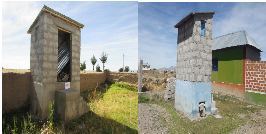
Figura 9. Letrinas de doble cámara con deficiencias en la ejecución
