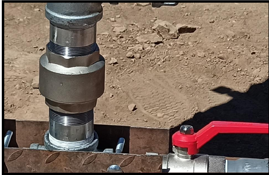
Figura 53: Válvula de descarga instalada.
