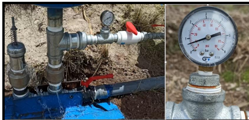
Figura 66: Medición de presión (cuando la llave de descarga está cerrada)
