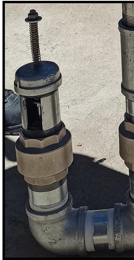
Figura 52: Válvula de impulsión instalada.
