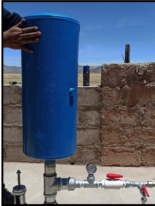
Figura 55: Cámara de aire instalada.
