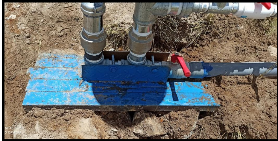
Figura 63: Bomba de ariete montado a la plataforma.
