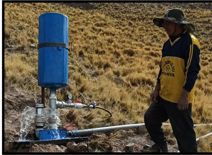
Figura 67: Bomba de ariete hidráulico en funcionamiento.
