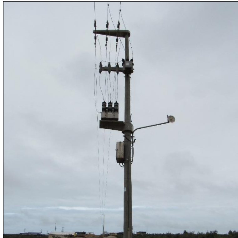
Figura 8: Recloser (NR002), instalado en la estructura O163-389 (Elaborado por el equipo de trabajo)
