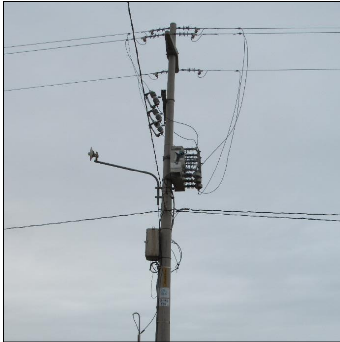
Figura 10: Seccionalizador (SSA01), instalado en la estructura O162-827
