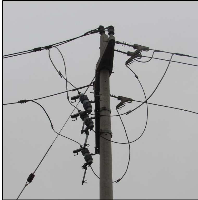
Figura 11: Seccionador tipo CUT-OUT (O165-287)
