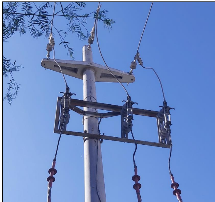
Figura 13: Seccionador tipo cuchilla, instalado en la estructura O164-1020
