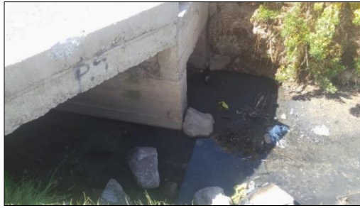
Figura 80: Arrojo de residuos y descarga de desagüe
