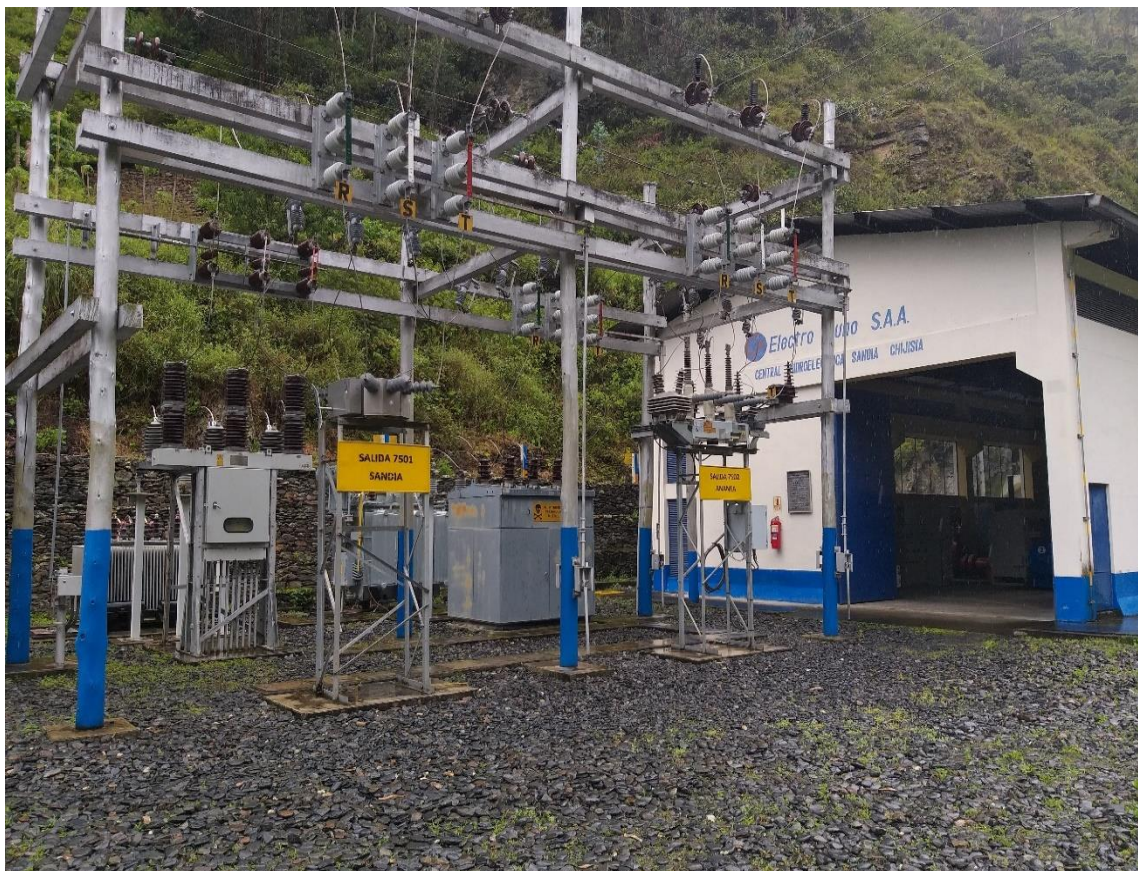
Figura N° 4.1: Central hidroeléctrica de chijisjá
