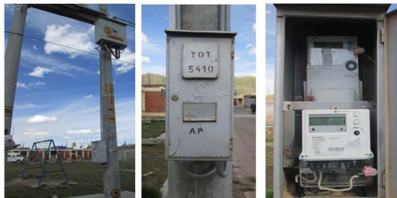
Figura N° 13: Medidor totalizador y de alumbrado público en SED
