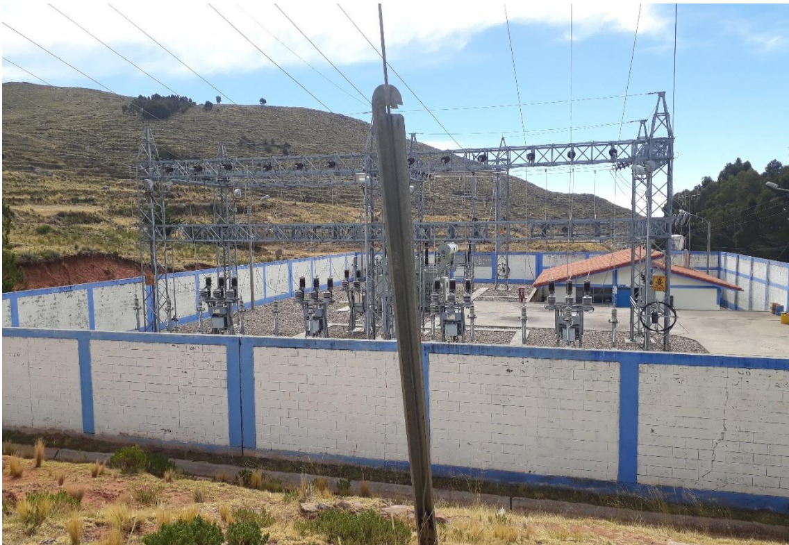
Figura N° 6.1: sub estación de transformación de Pomata.
