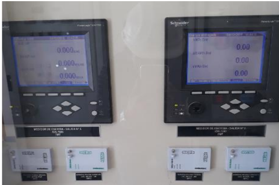
Figura N° 12: Medidores de energía instalados en los SET
