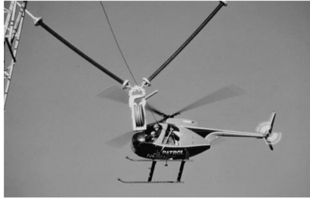
Figura N° 20: Línea piloto de instalación de helicópteros
