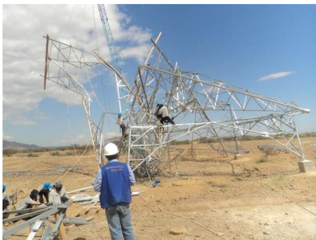
Figura N° 2: Caída de pluma por exceso de carga.
