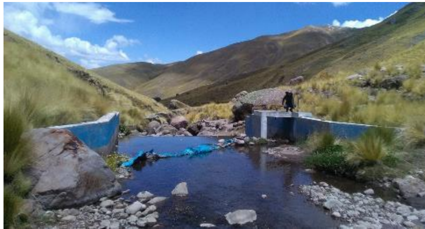
Figura 10: Captación de agua la quebrada Turmana.
