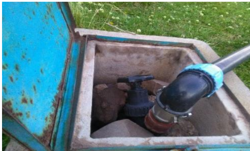
Figura 12: Hidrante de riego de operación manual.
