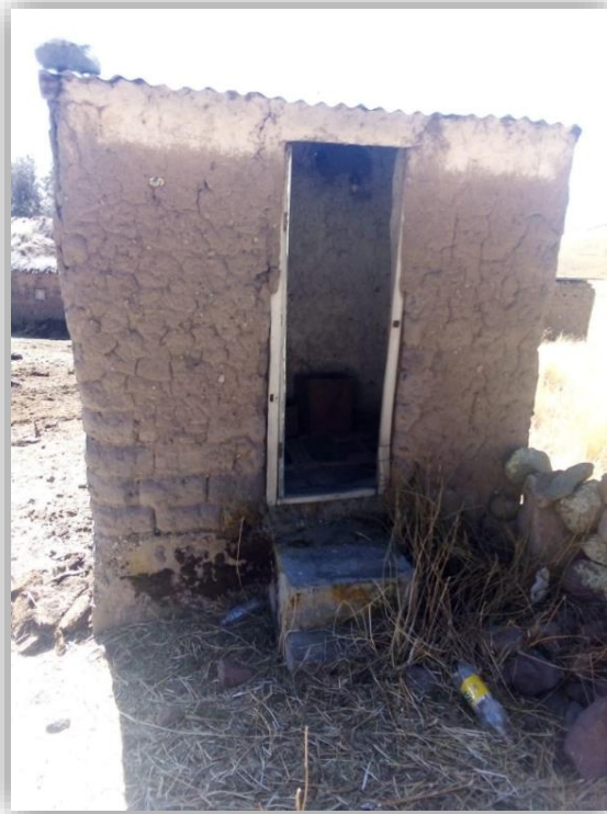
Figura 4: Unidad básico de saneamiento de tipo abonera UBS-C, ejecutado en la primera etapa
