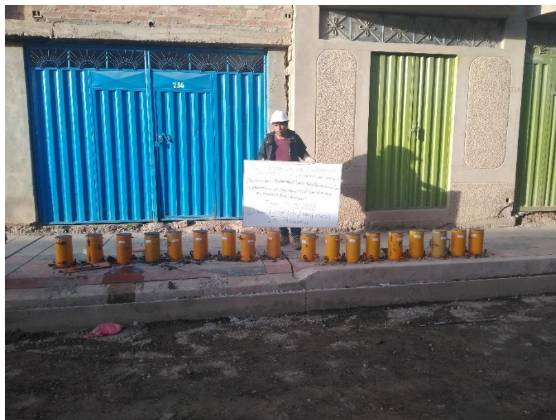
D4. Toma de 09 muestras de concreto para la condición de curado estándar del segundo punto.
