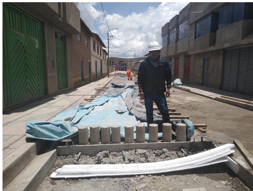
D6. Colocación en la misma estructura del lugar donde se tomó la muestra para el curado en obra.
