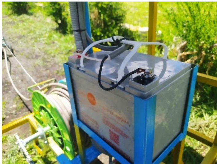
Figura N°135: Montaje de Batería.
