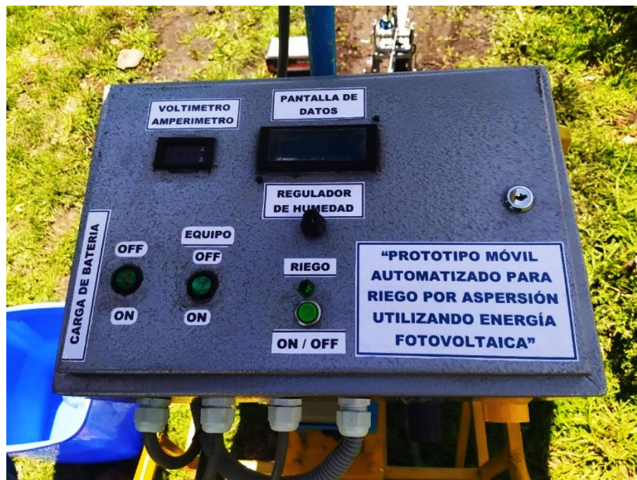
Figura N°129: Tablero de control.
