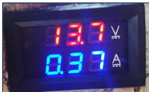
Figura N°112: Visor de datos de voltaje y corriente de funcionamiento.
