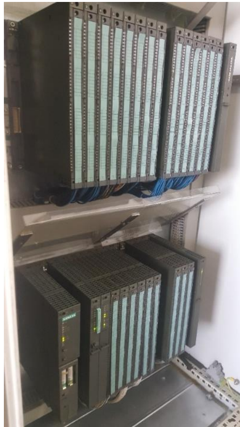
Figura A.2: Tablero del PLC S7-416 Planta Piloto Backus-Ate.
