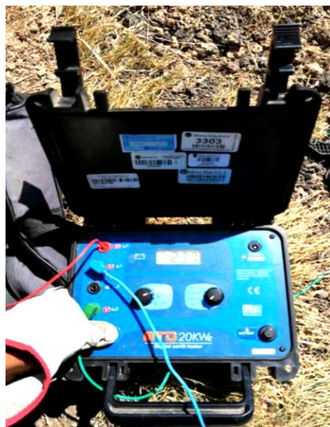
Figura N° 4. 44: Medición de resistencia del PAT salida a Asillo
