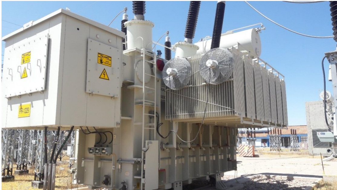
Figura N° 3. 4: S.E. Azángaro. Transformador de potencia tres devanados YN0yn0d5 S.E. Azángaro
